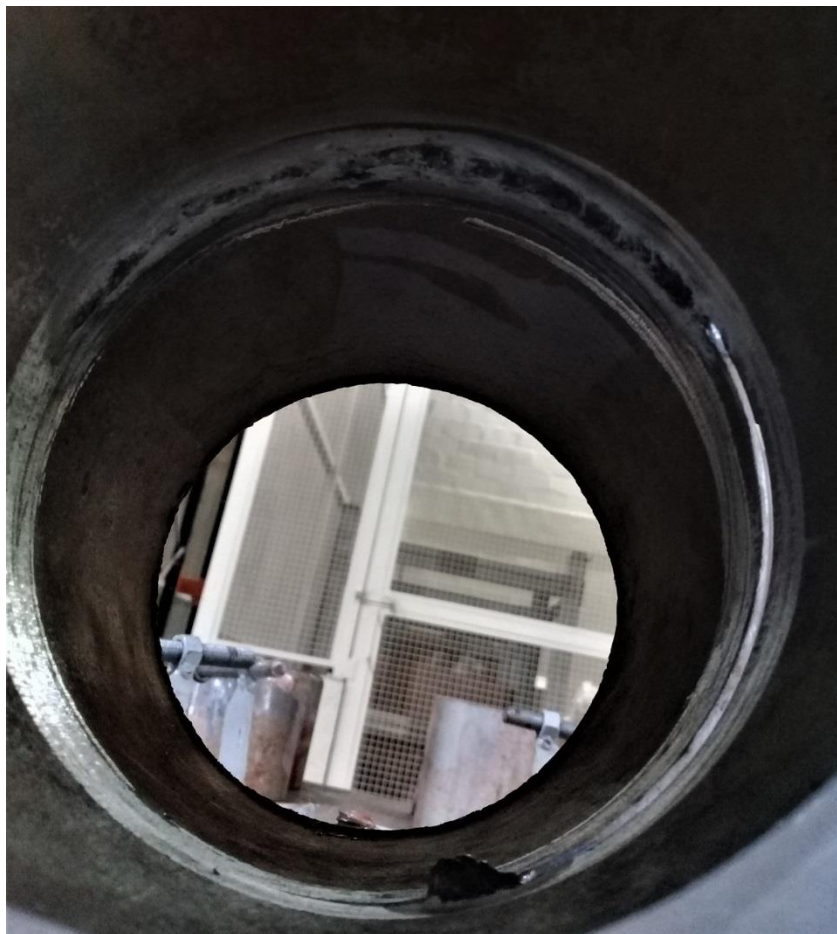
Figura 5 – Excesso de penetração na soldagem
