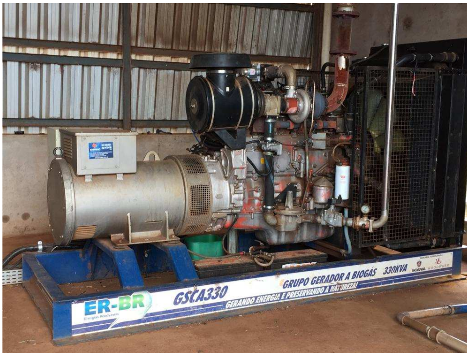
Figura 7 – Gerador de energia
