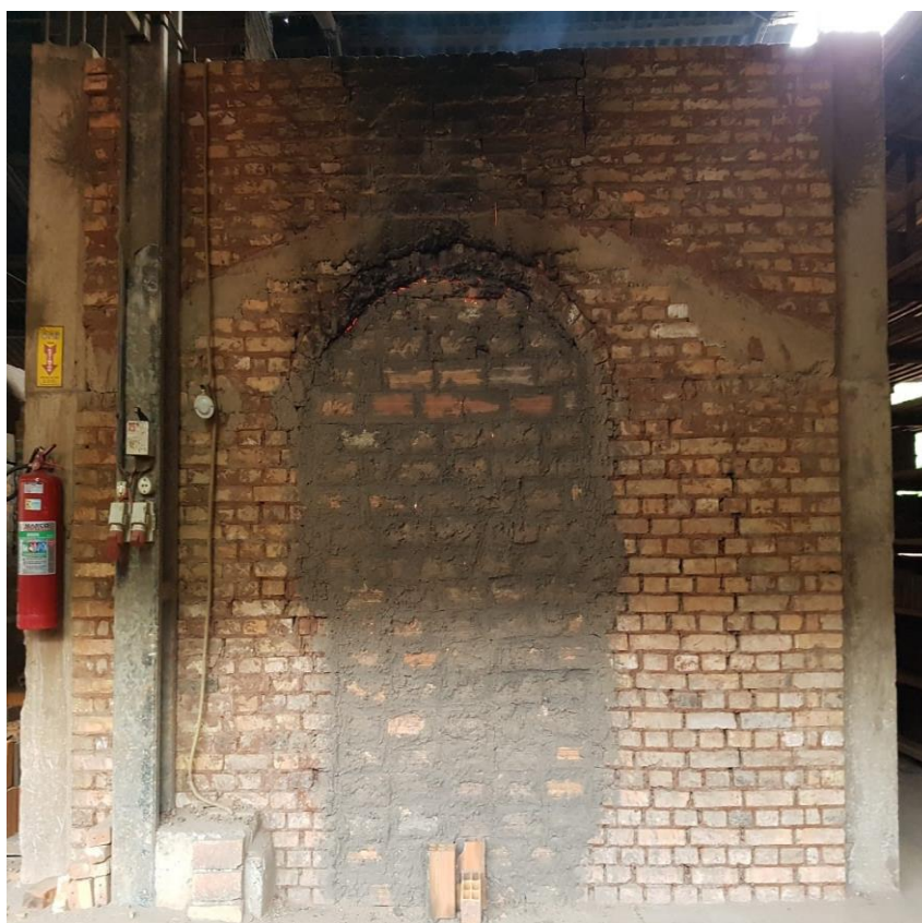
Figura 3.1: Forno utilizado para execução do projeto
