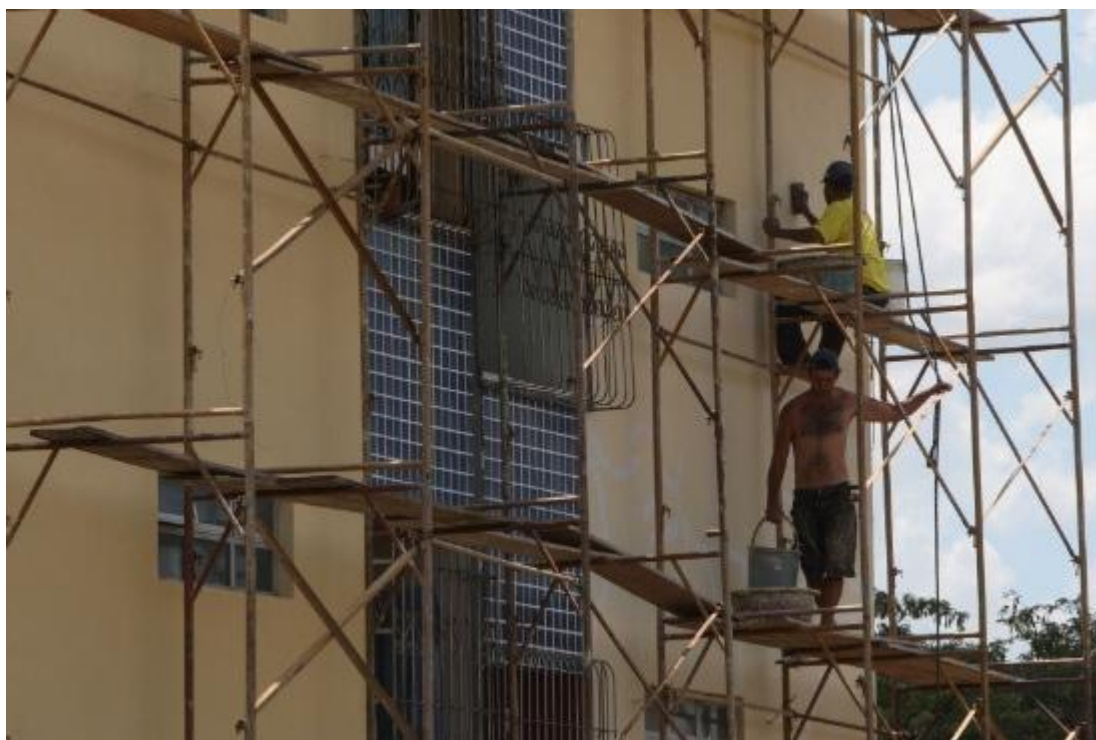
Figura 2: Falha de instalação de equipamentos e falta de utilização de EPI's.
