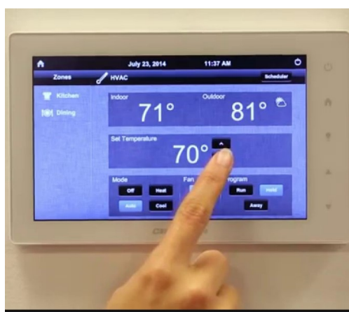
Figura 05: Controle da climatização por controle remoto - Domótica:
