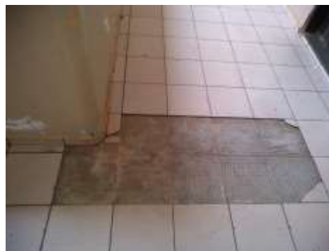
Figura 45 - Precariedade do piso
