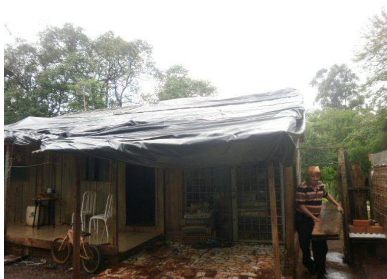
Figura 19: Casa destelhada em vendaval em Cascavel.
