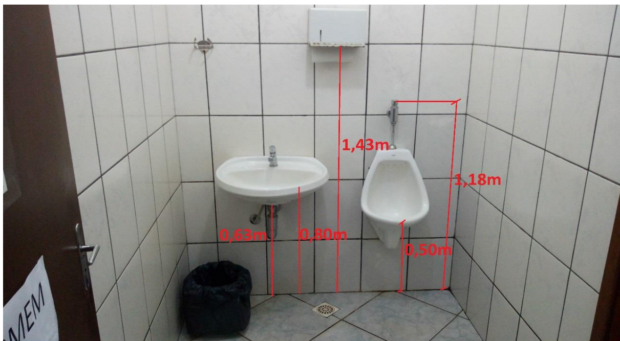
Figura 29: Lavatório e Mictório.
