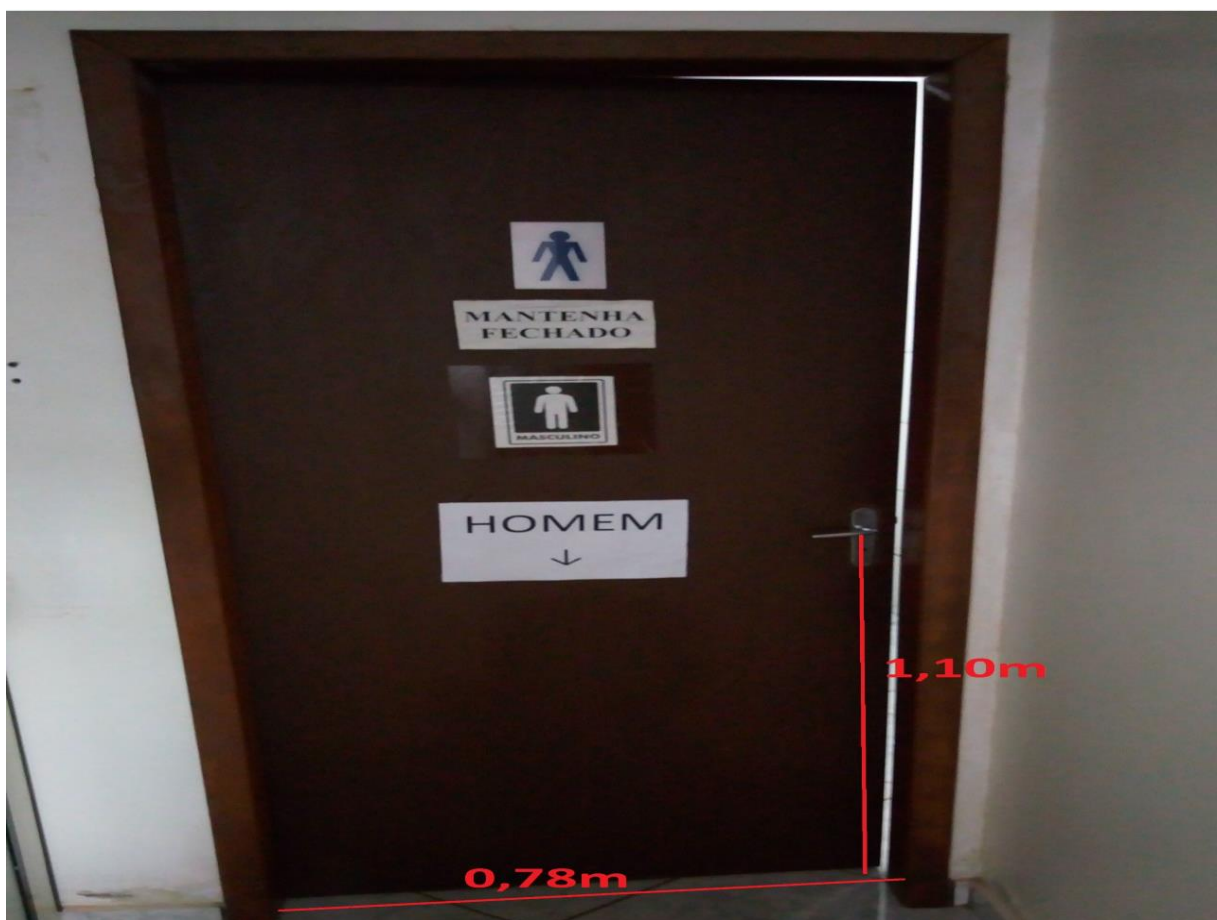
Figura 27: Abertura da porta Sanitário.
