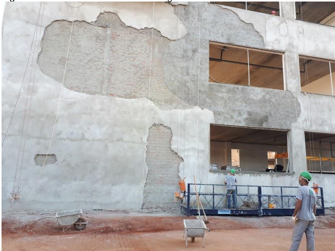
Figura 8 - Descascamento do revestimento argamassado.
