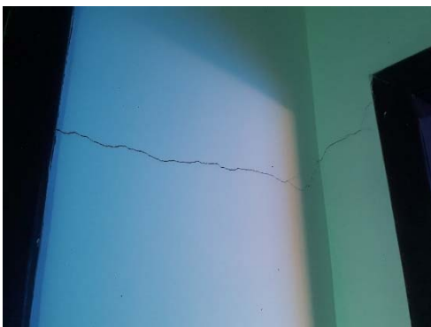
Figura 03: Fissura em alvenaria
