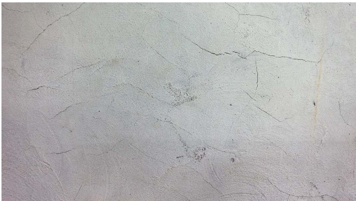
Figura 04: Fissura em revestimento
