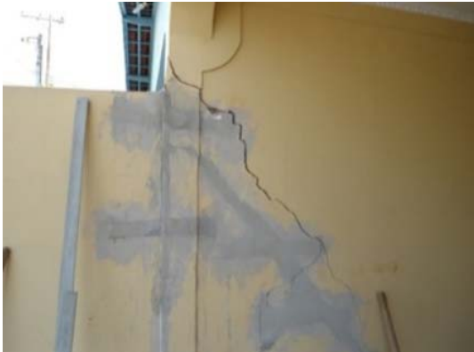
Figura 02: Anomalia gerada pela deformação do aterro
