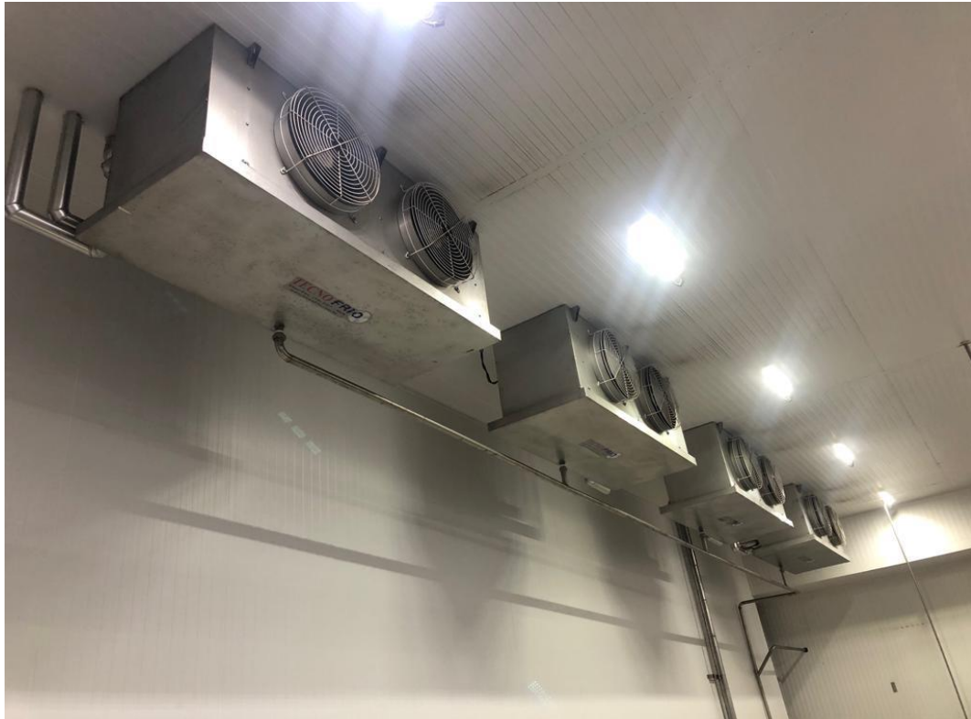
Figura 19: Evaporadores de ar com convecção forçada
