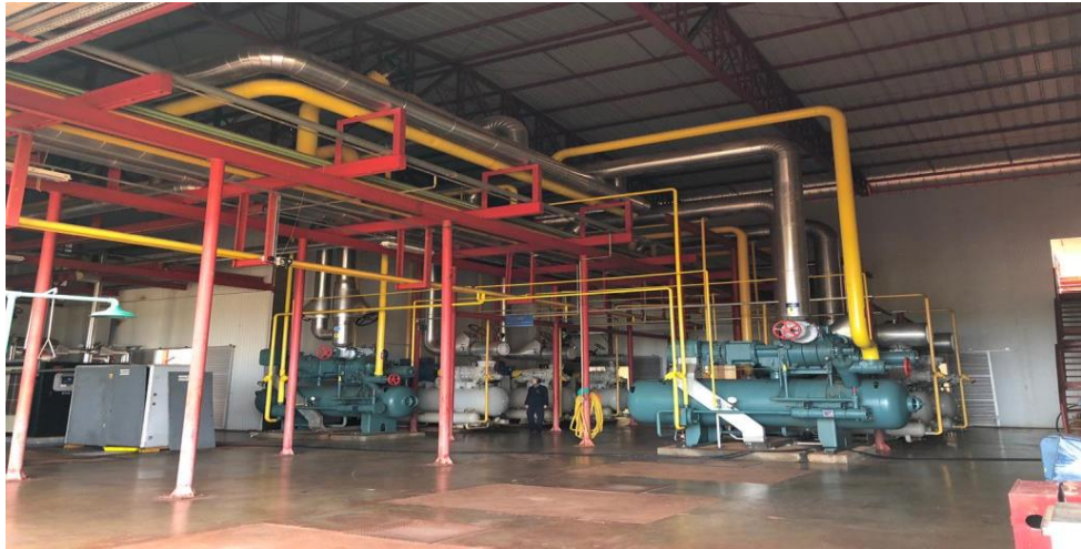
Figura 27: Espaço físico para os dois novos compressores
