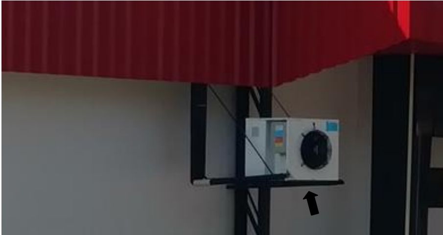
FIGURA 21: Condensador da Câmara Frigorífica
