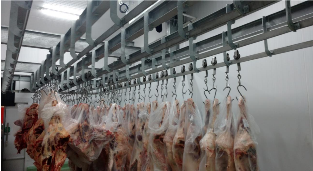
FIGURA 18: Parte interna Câmara Frigorífica
