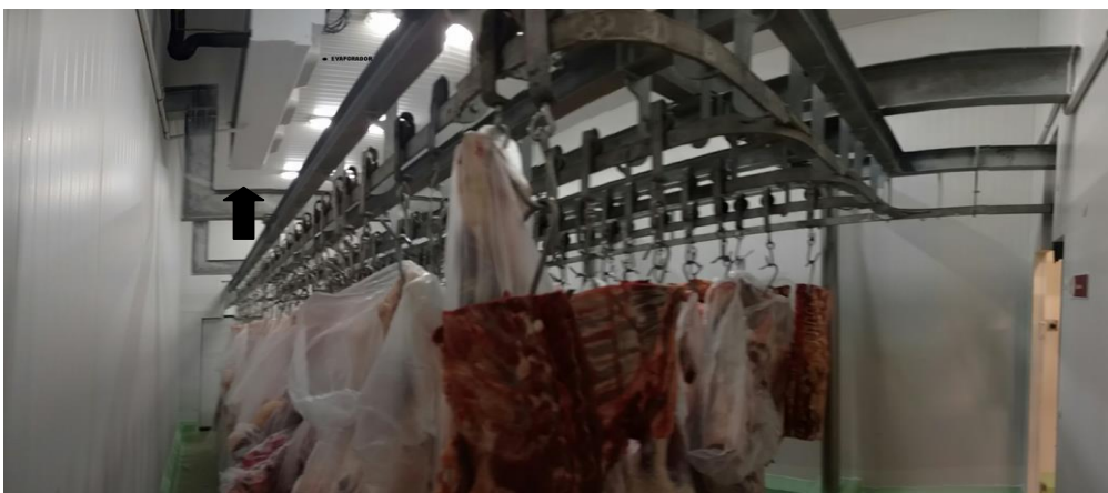
FIGURA 20: Evaporador da Câmara Frigorífica
