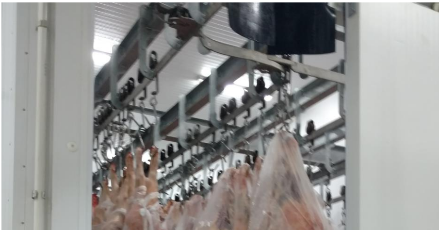
FIGURA 22: Trilhamento interno da Câmara Frigorífica
