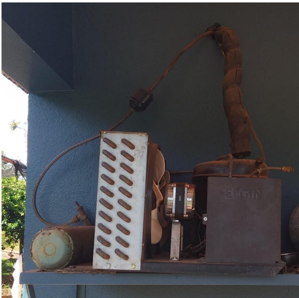
Figura 6: Unidade Condensadora. (Fonte: Autor)
