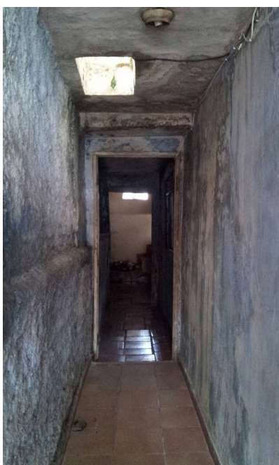
Figura 12: Condições da casa antes da reforma.
