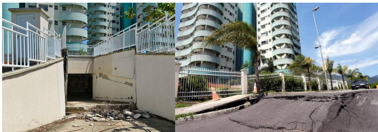
Figura 21: Entrada da Garagem de um dos Prédios da Vila; Ruas com Problema de Afundamento.
