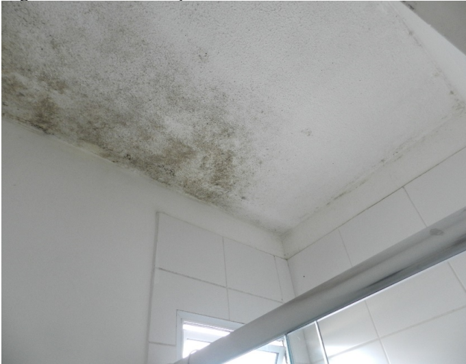
Figura 13: Manifestação de bolor no banheiro.
