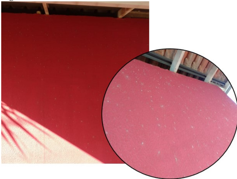
Figura 9: Bolor em fachada.
