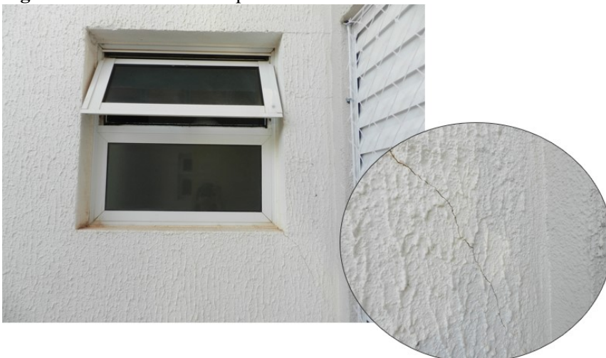
Figura 4: Fissura 45° de esquadrias.
