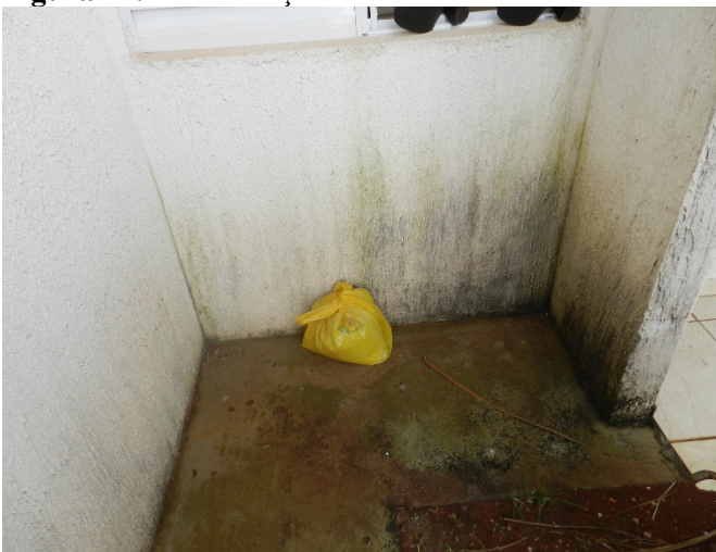
Figura 14: Manifestação de bolor na fachada.
