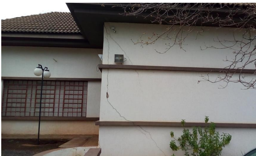
Figura 11: Fendas em parede.
