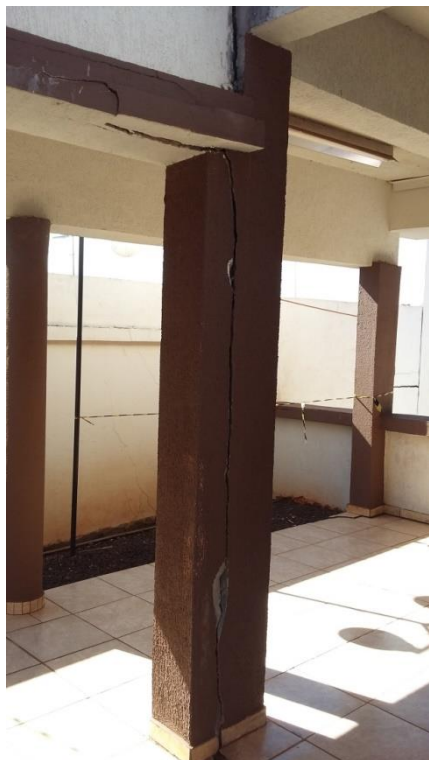
Figura 8: Fendas em pilar.
