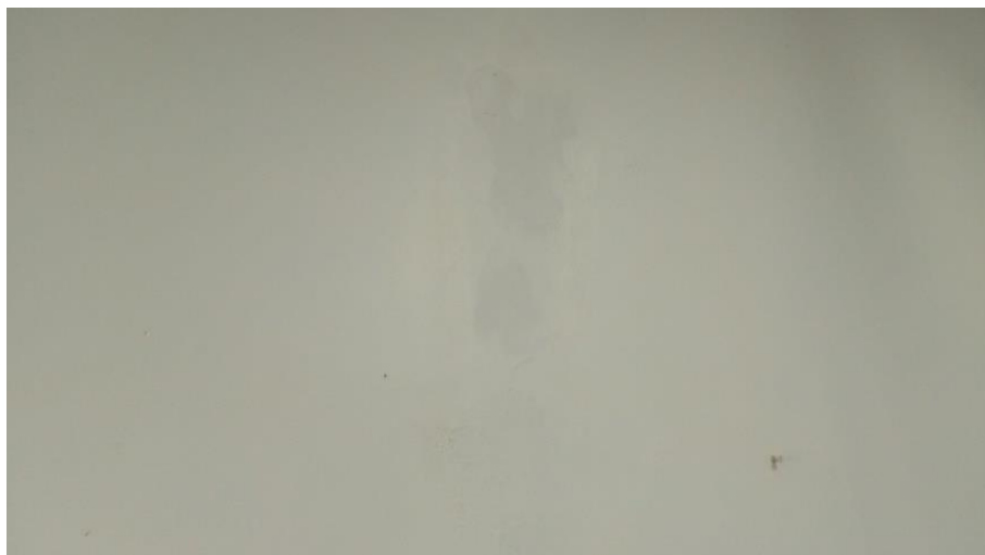
Figura 1: Machas ocasionadas pela umidade.
