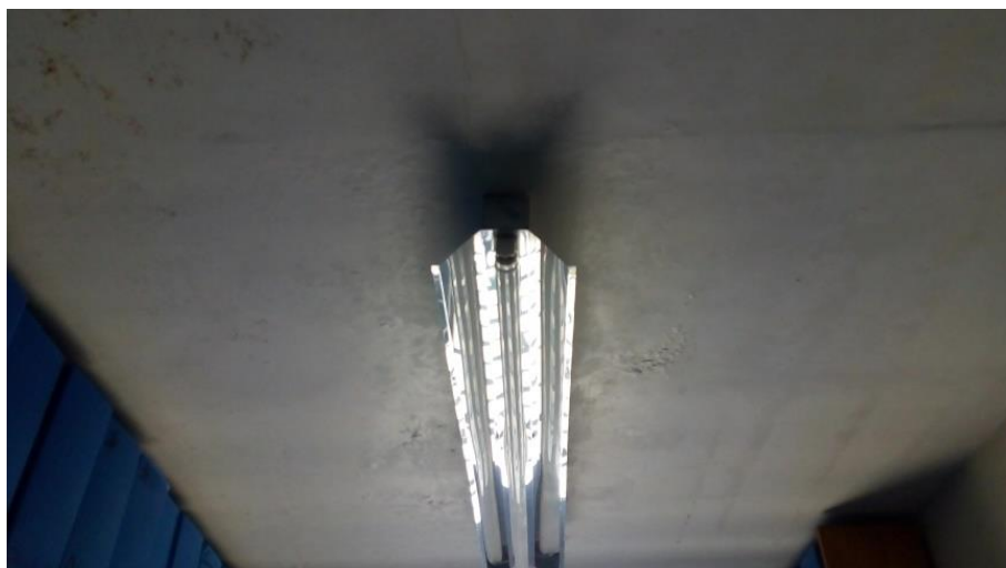
Figura 2: Infiltração no teto.
