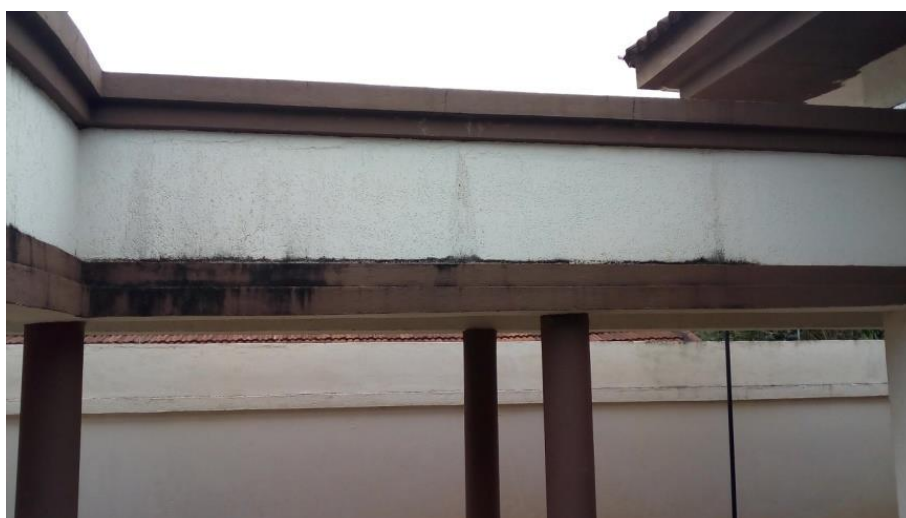
Figura 4: Bolor na parede.
