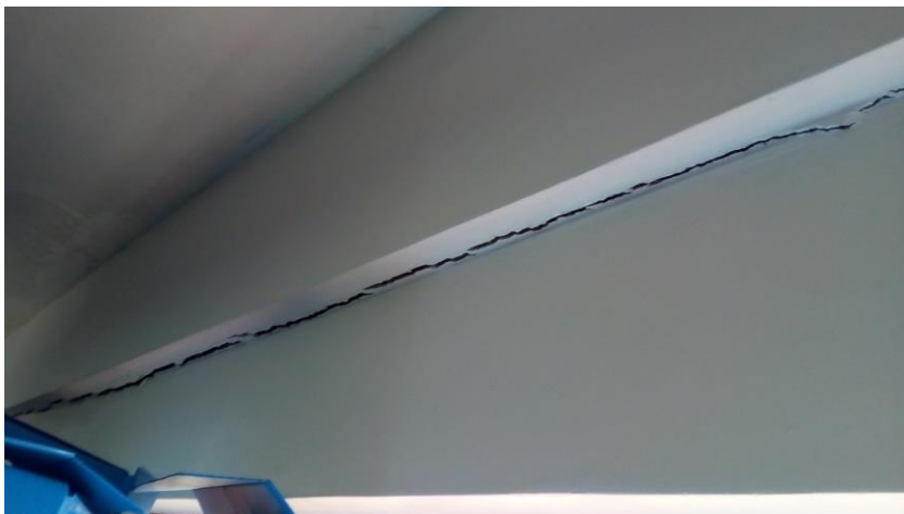
Figura 10: Fendas em viga.
