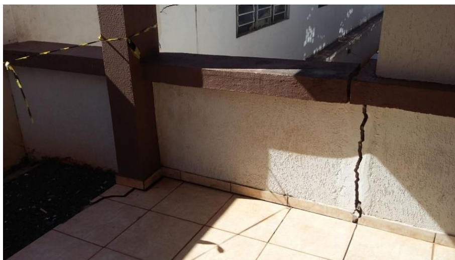
Figura 09: Fendas em viga.
