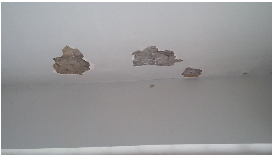
Figura 5: Descolamento de revestimento.
