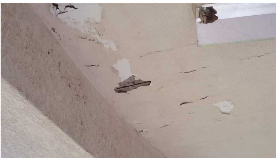
Figura 14: Corrosão da armadura.
