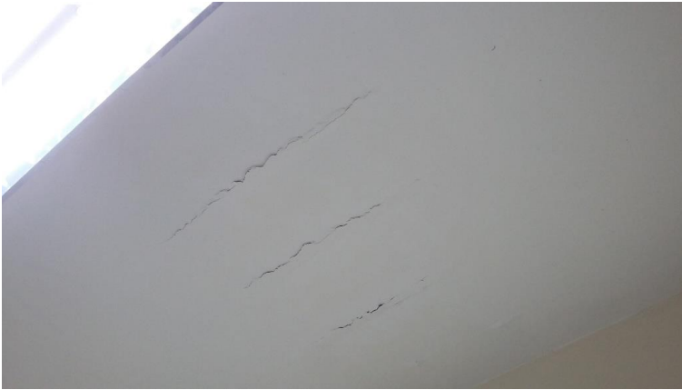
Figura 7: Trincas e fissuras na laje.
