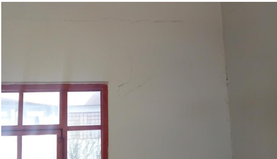
Figura 6: Trincas e fissuras nas paredes.
