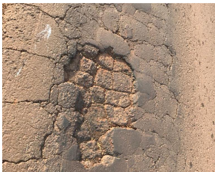
Figura 1: Trinca tipo bloco.
