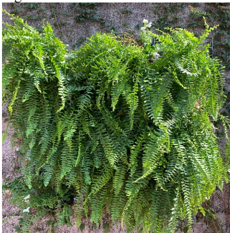
Figura 4 - Parede verde instalada na fachada da residência A
