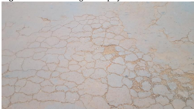
Figura 9: Trinca interligada – tipo jacaré
