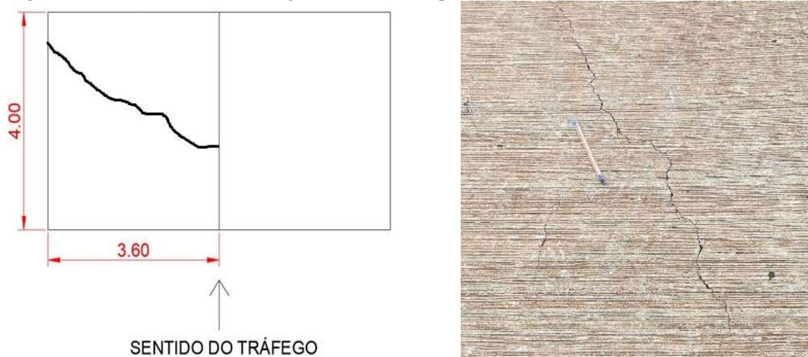
Figura 4: Ilustração da fissura diagonal e fissura em pavimento.
