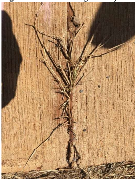
Figura 9: Falha de selagem nas juntas.
