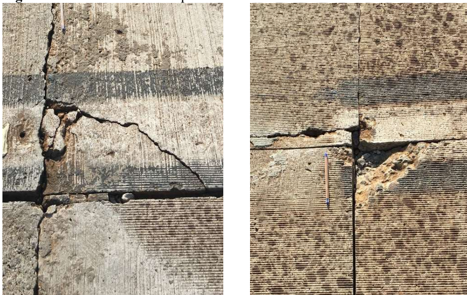
Figura 7: Esborcinamento ou quebra de canto.
