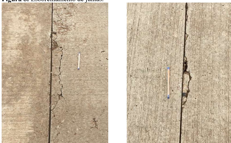
Figura 8: Esborcinamento de juntas.
