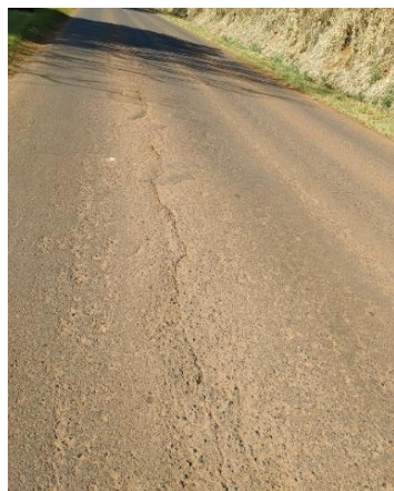
Figura 13: Trinca longitudinal longa KM 39 lado esquerdo
