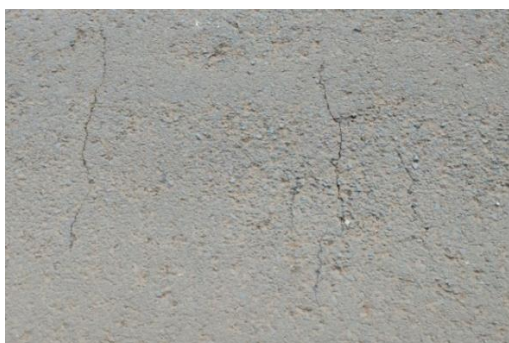
Figura 11: Trinca transversal curta KM 40 lado direito
