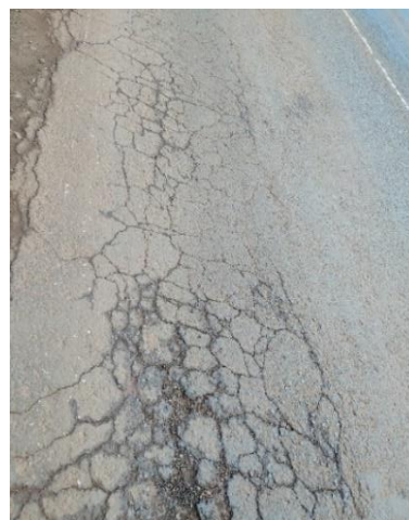
Figura 10: Trinca couro de jacaré KM 40 lado esquerdo
