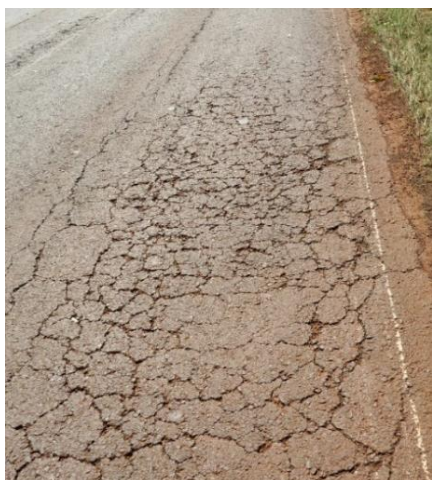
Figura 9: Trinca couro de jacaré KM 37 lado direito
