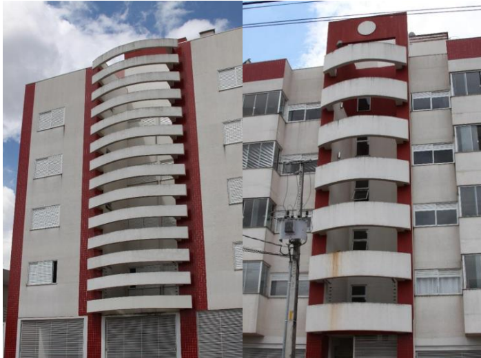
Figura11 : Manchas na Fachada Oeste e Sul.
