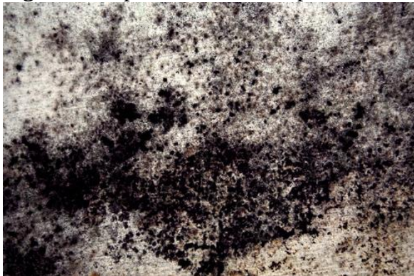
Figura 4: Aspecto do mofo nas paredes.
