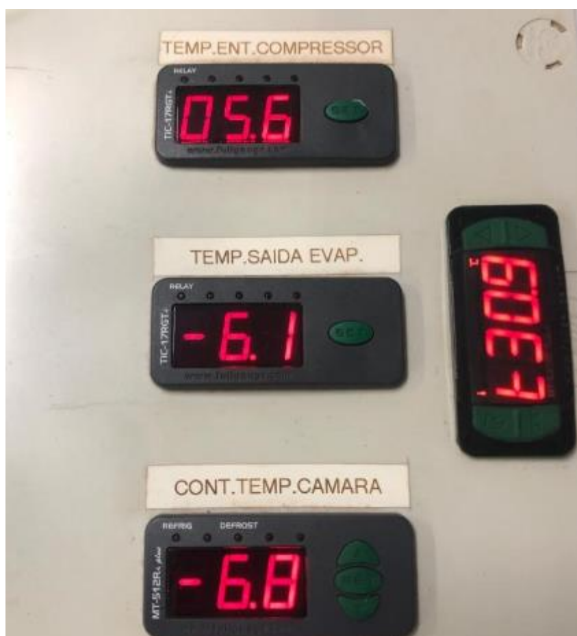
Figura 30: Display da bancada demonstrando a temperatura interna da câmara antes do processo de degelo.
