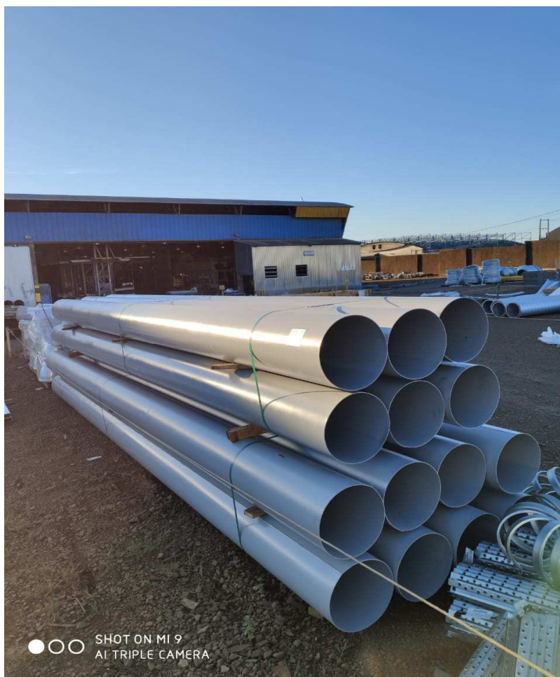
Figura 6: Tubulação sem revestimento interno.
