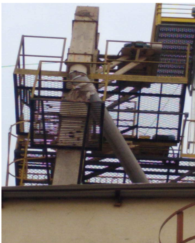
Figura 7: Tubulação envolvida por plástico, para evitar o vazamento de produtos.
