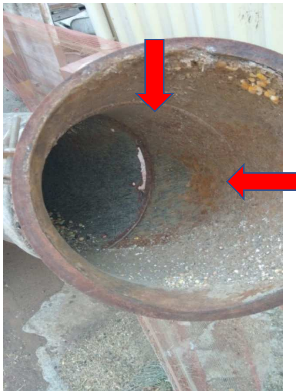
Figura 9: Desgaste interno da canalização sem revestimento por grade interna.
