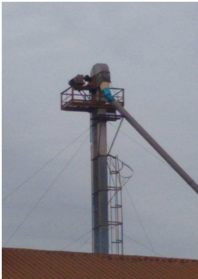
Figura 8: Tubulação envolvida por plástico, para evitar o vazamento de produtos.
