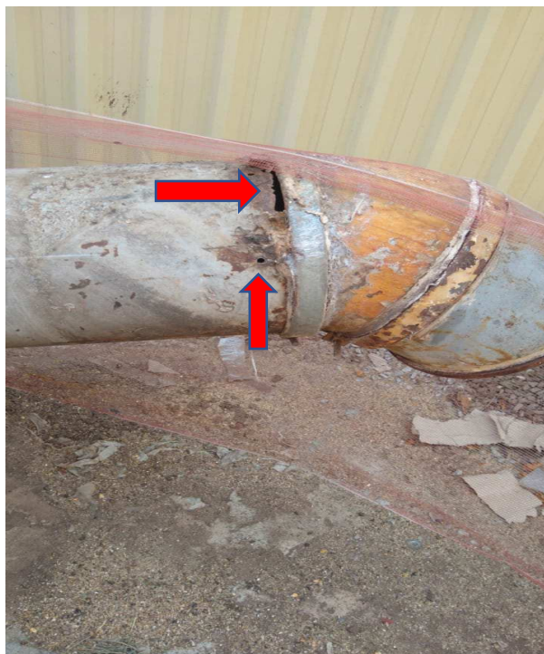
Figura 10: Ruptura externa da canalização sem revestimento por grade interna.
