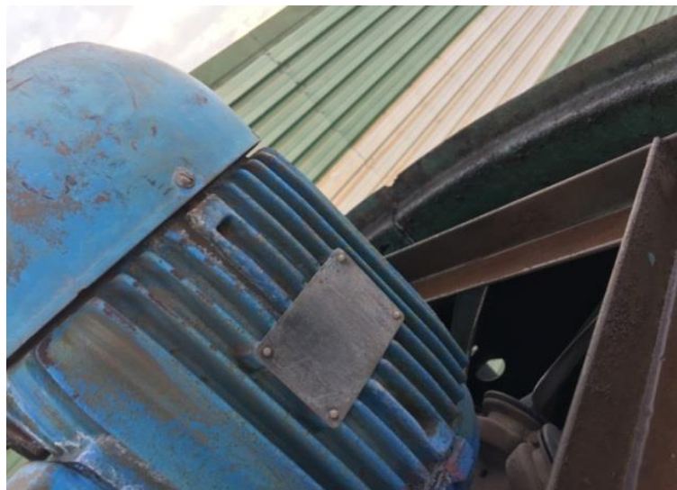
Figura 15: Deterioração da plaqueta de identificação do motor da torre
