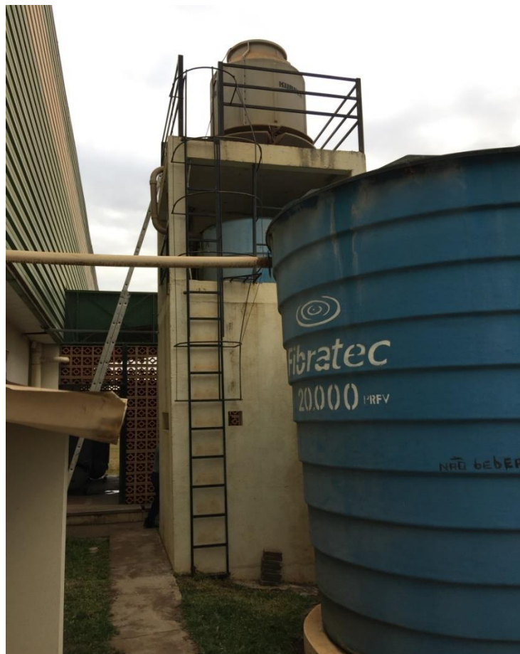
Figura 12: Torre de resfriamento de água na qual as medições foram conduzidas
