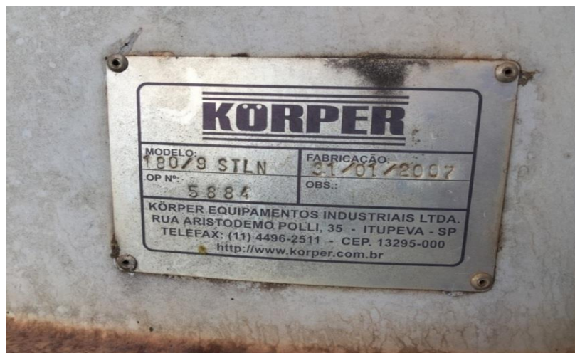
Figura 13: Plaqueta de identificação da torre de resfriamento de água
