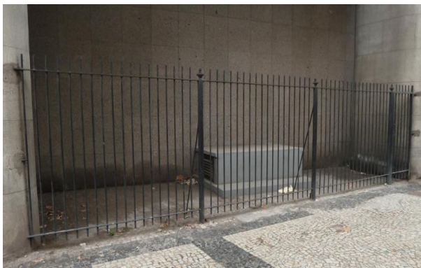
Figura 15 – Cercas de ferro impedindo a permanência debaixo do espaço desocupado.
