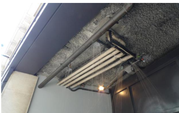
Figura 13 – Chuveirinho instalado sob marquise de edifício residencial.
