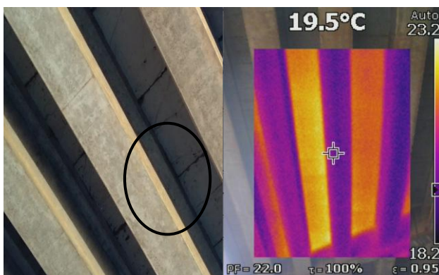
Figura 48 Termografia prováveis fissuras no tabuleiro
