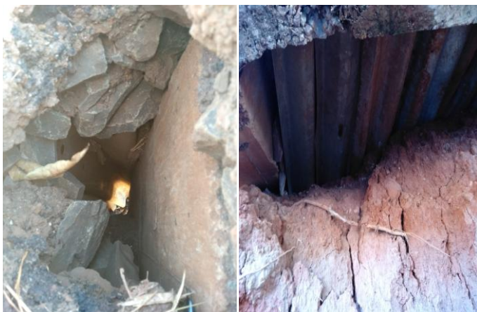
Figura 43 Erosão de talude
