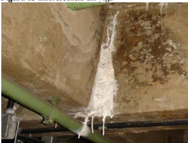
Figura 13 Eflorescência em viga
