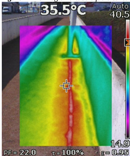
Figura 47 Termograma tubulação elétrica
