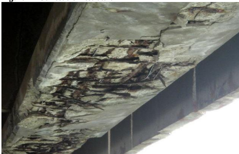
Figura 17 Corrosão em estrutura
