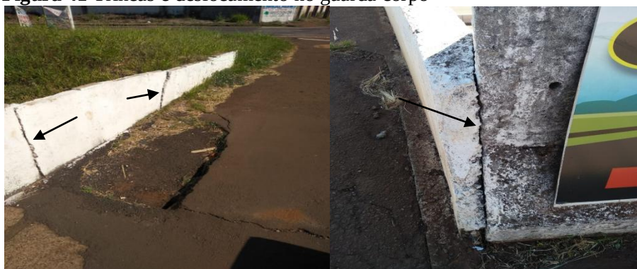
Figura 41 Trincas e deslocamento no guarda corpo
