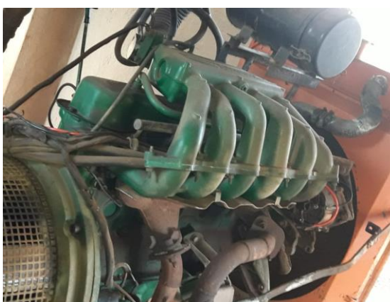
Imagem 2 – Gerador de energia
