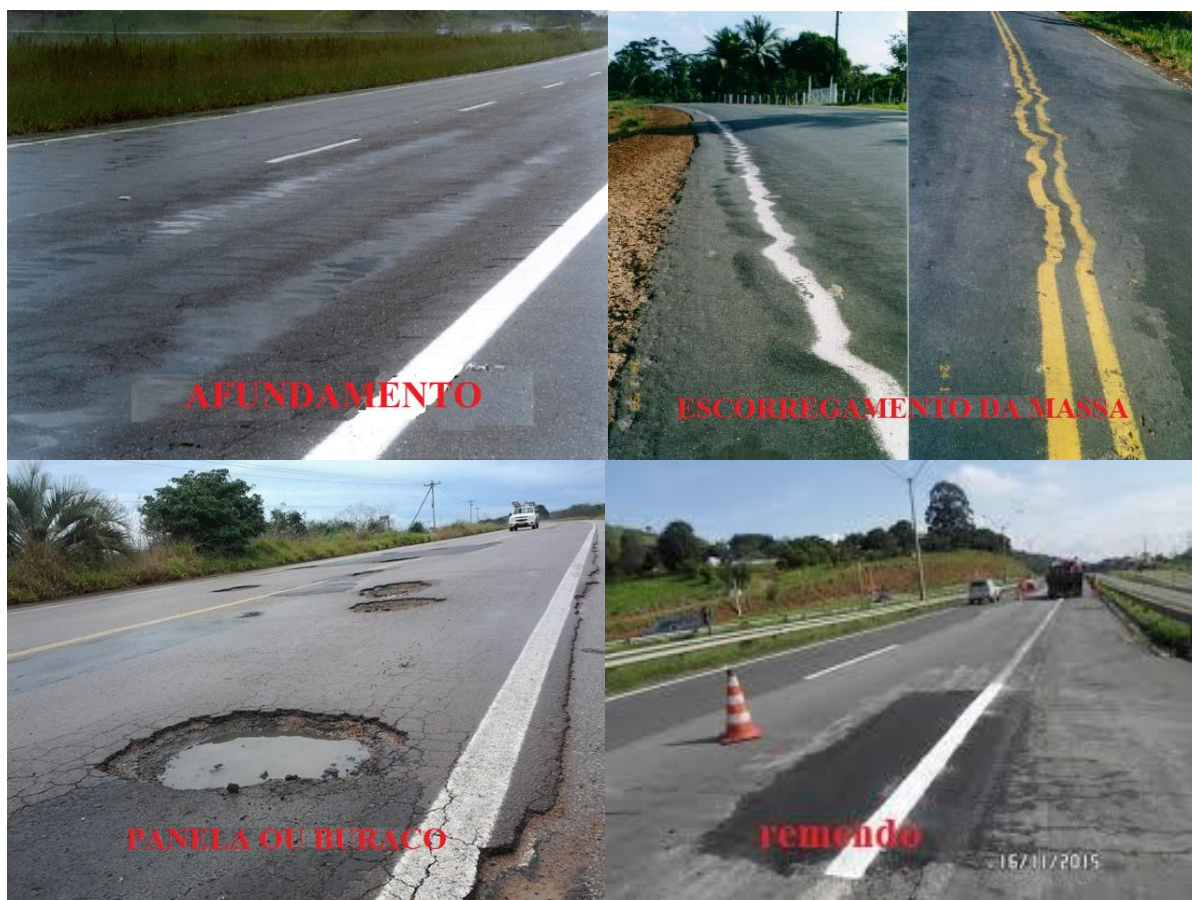
Figura 3: Afundamento, Escorregamento da massa, Painéis e remendo.
