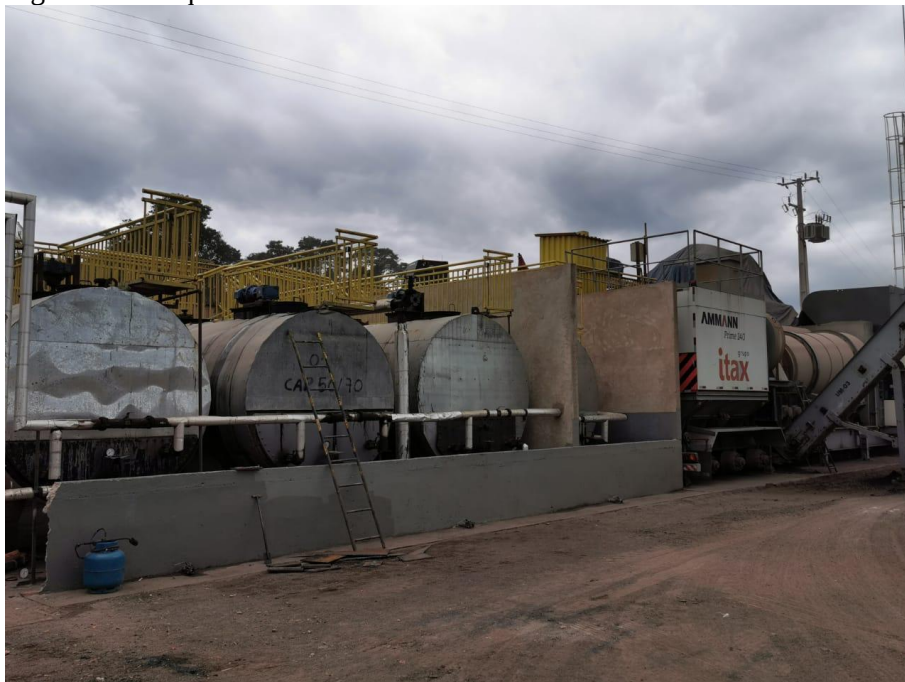
Figura 1 – Tanque de armazenamento asfáltico da usina Itax.
