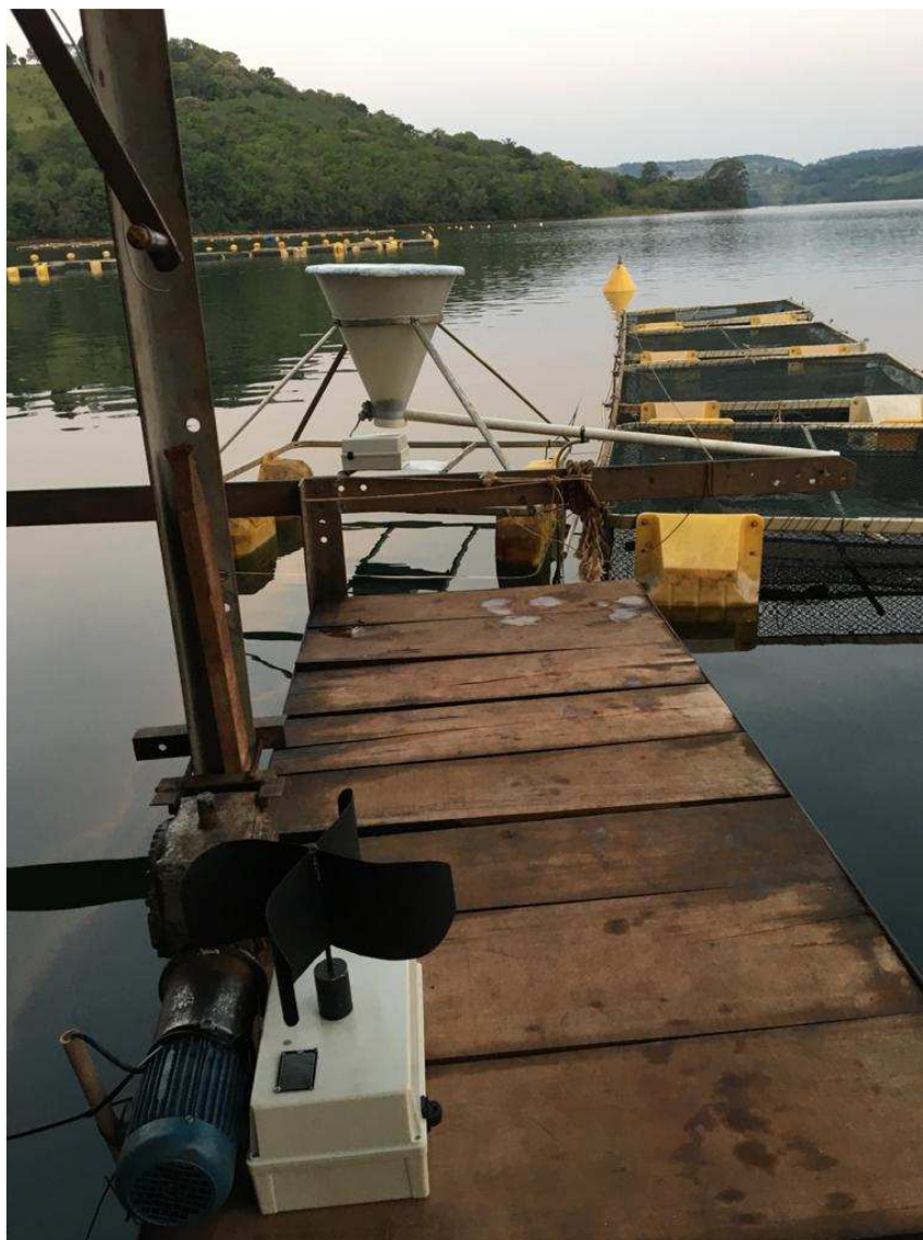
Figura 51: Sistema instalado na piscicultura.
