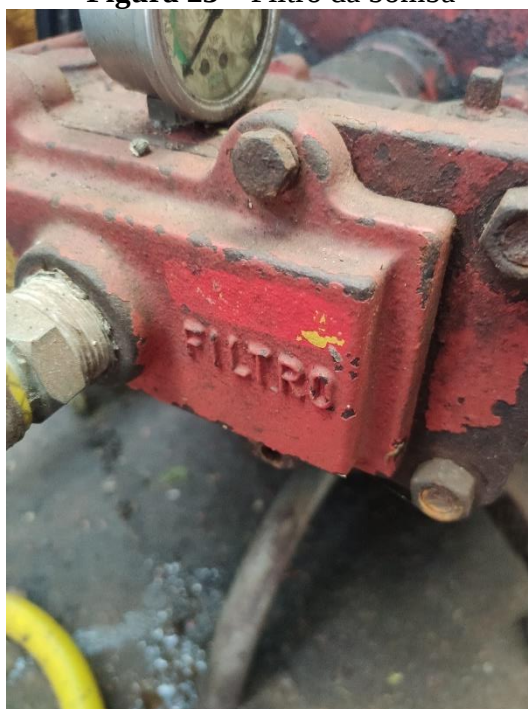
Figura 23 – Filtro da bomba
