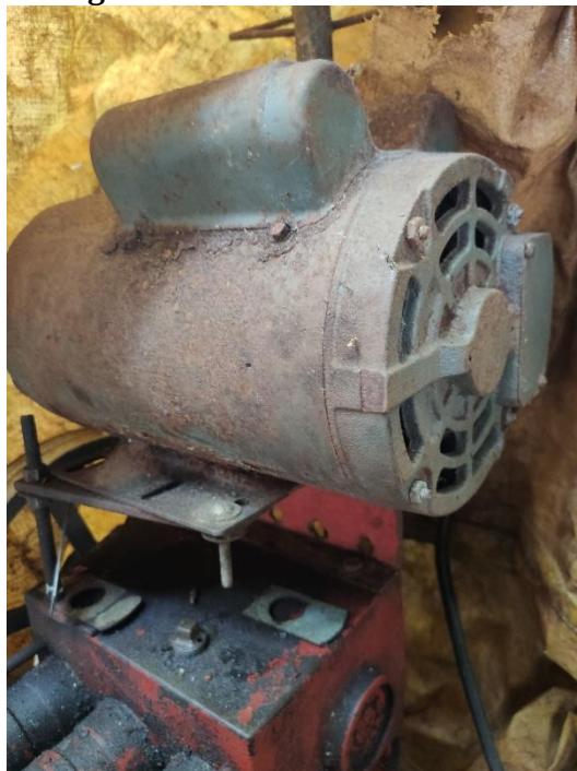
Figura 22 - Motor elétrico bomba
