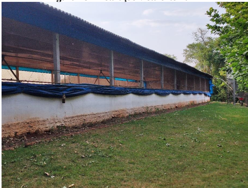
Figura 28 - Instalação vista externa "2"
