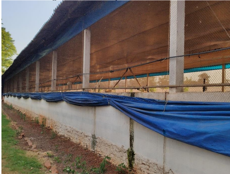
Figura 27 - Instalação vista externa "1"
