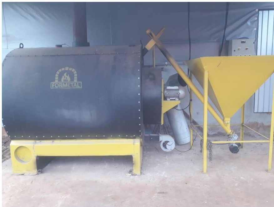
Figura 8: Forno com sistema de aquecimento a Pellet (Fonte: Autor, 2020)
