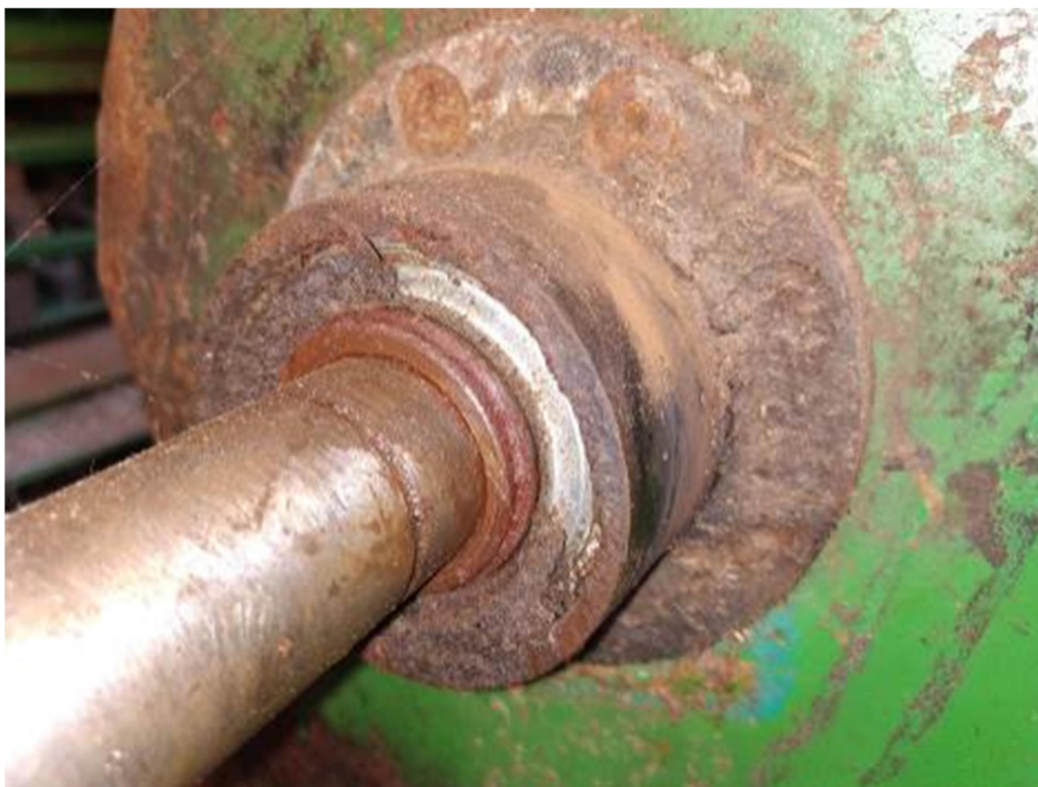
Figura 3: Fotografia retirada pelo regulador do mancal e rolamento do eixo com alto grau de severidade, em que é possível evidenciar a falta de lubrificação nas partes móveis (Fonte: Acervo dos autores, 2020)
