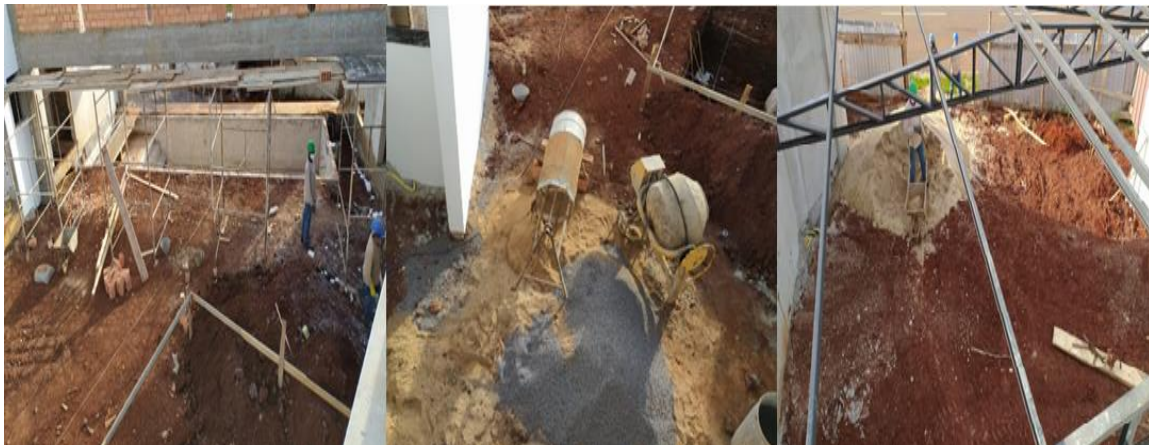
Figura 11: Problemas com utilização e organização na central de argamassa.
