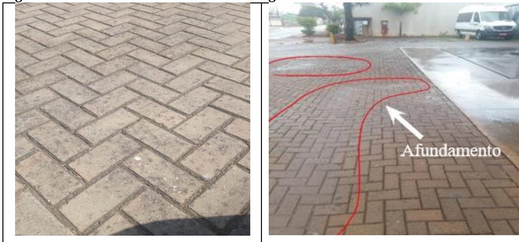
Figura 9: Pavimento intertravado nivelado. Figura 10: Pavimento intertravado com afundamento.
