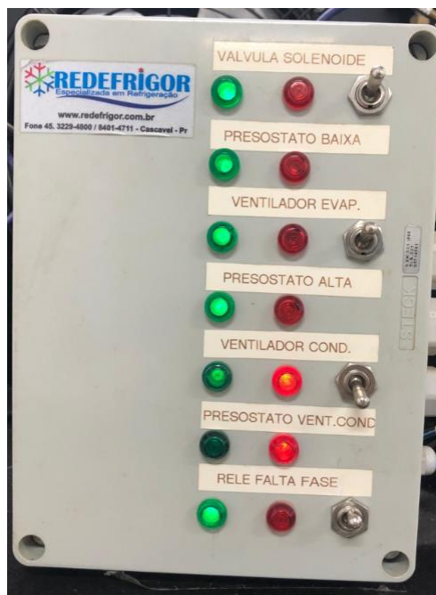
Figura 23 - Chaves de controle do painel
