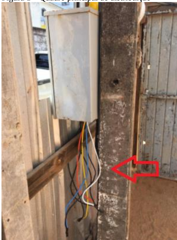
Figura 1 – Quadro principal de distribuição
