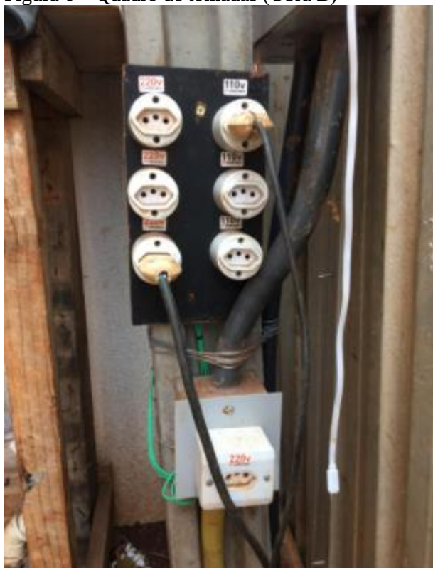
Figura 6 – Quadro de tomadas (Obra B)
