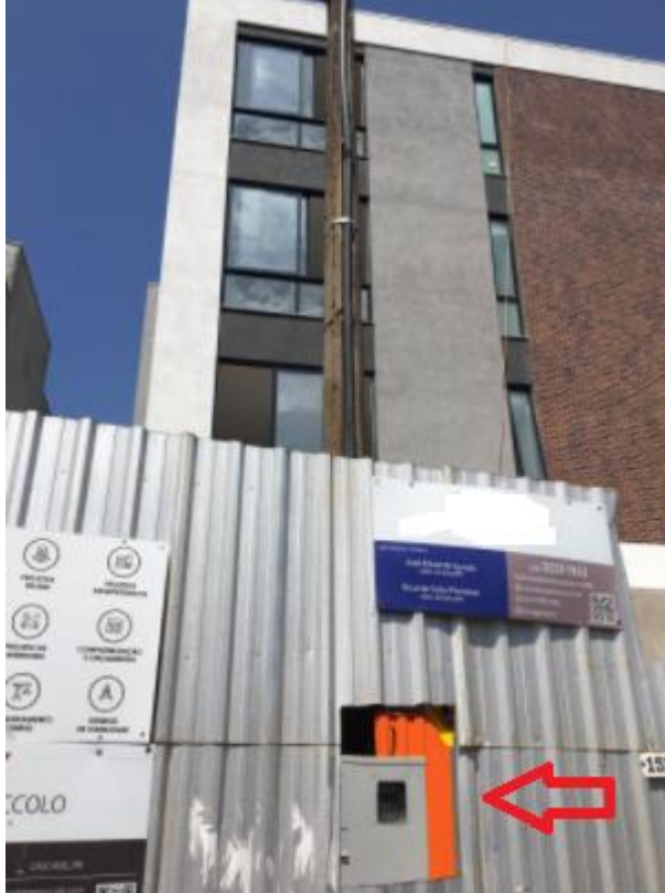
Figura 2 – Quadro principal de distribuição (Obra A)
