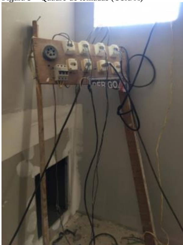
Figura 5 – Quadro de tomadas (Obra A)
