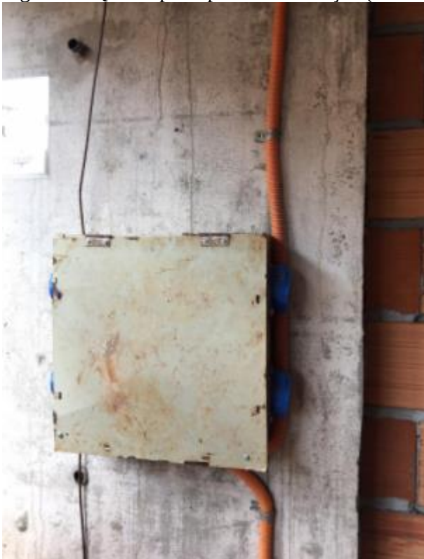
Figura 4 – Quadro principal de distribuição (Obra C)
