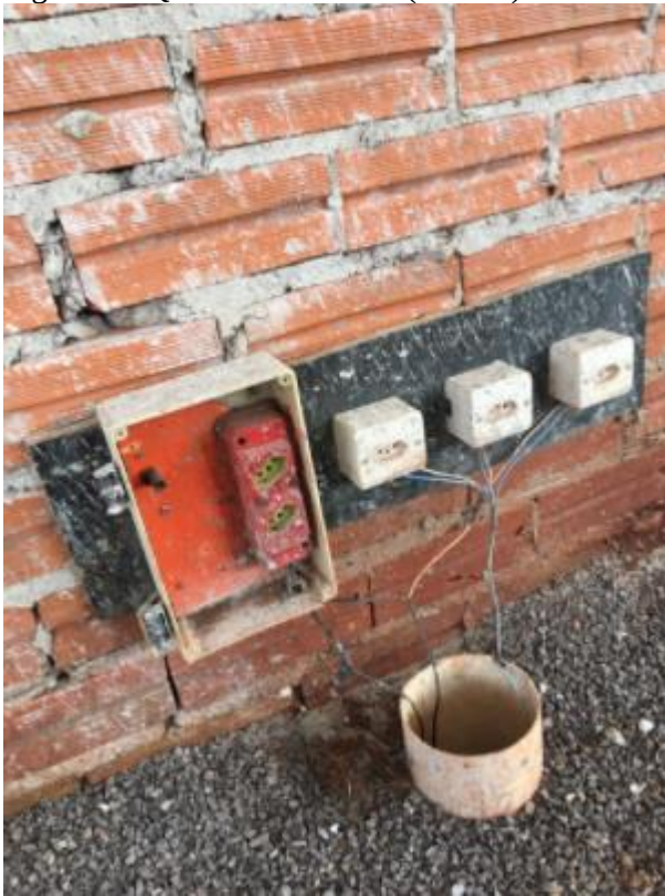
Figura 7 – Quadro de tomadas (Obra C)
