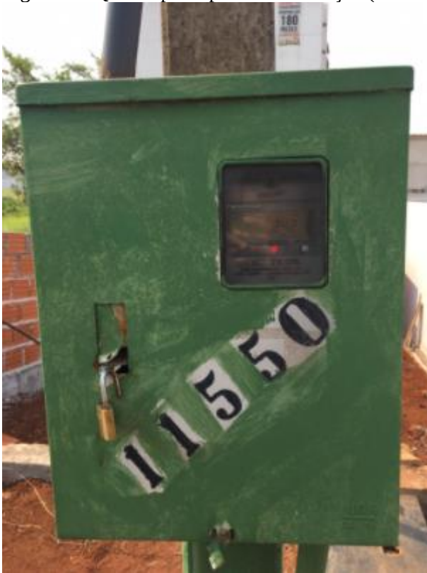
Figura 3 – Quadro principal de distribuição (Obra B)
