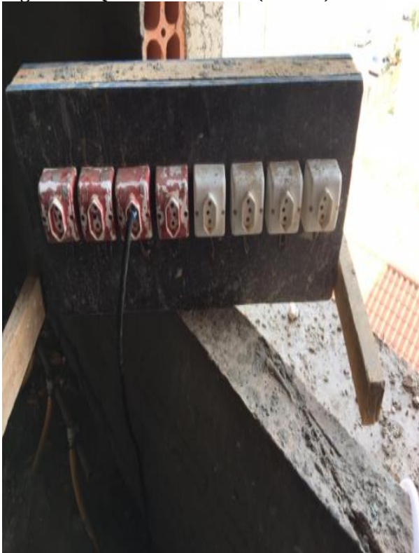
Figura 8 – Quadro de tomadas (Obra C)
