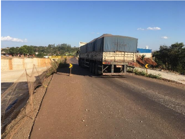
Figura 20: Sinalização inexistente Obra 1
