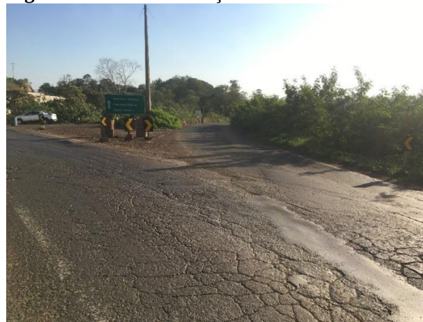
Figura 14: Falta canalização Obra 2
