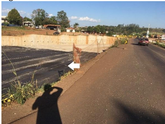
Figura 23: Tela caída Obra 1
