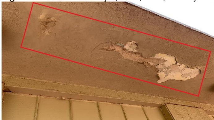
Figura 6: Bolhas de infiltração, bolor, mofo, infiltração e deterioração do concreto e argamassa
