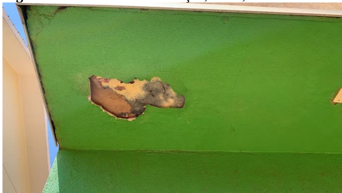
Figura 13: Manchas de infiltração, mofo, bolor e deterioração do concreto e argamassa
