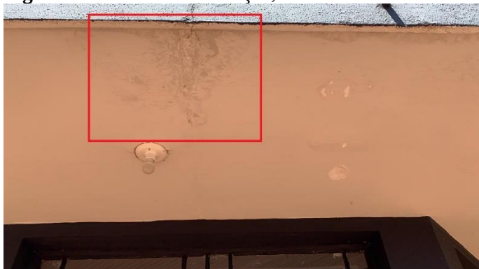
Figura 9: Mancha de infiltração, mofo e bolor
