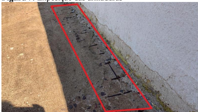
Figura 7: Exposição das armaduras
