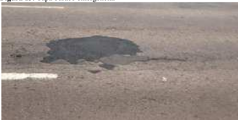
Figura 13: Tapa buraco emergencial
