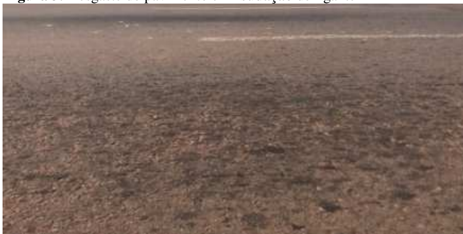
Figura 3: Desgaste do pavimento e Exsudação de ligante
