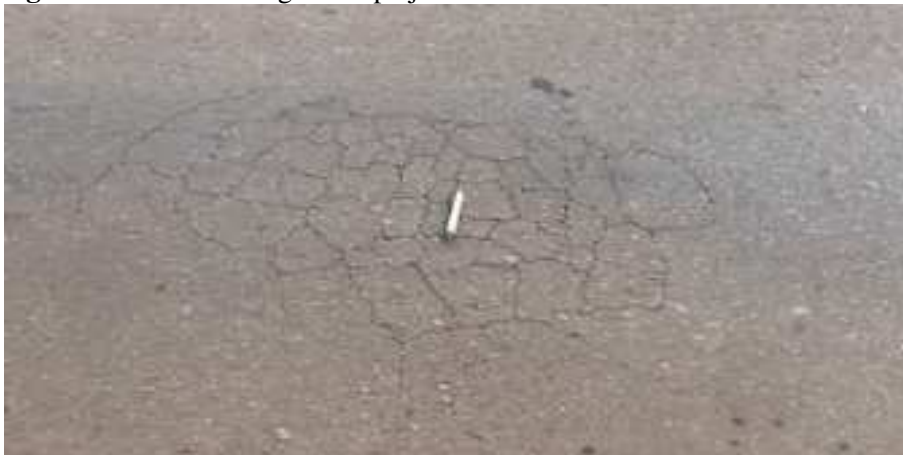
Figura 7: Trinca interligada - tipo jacaré
