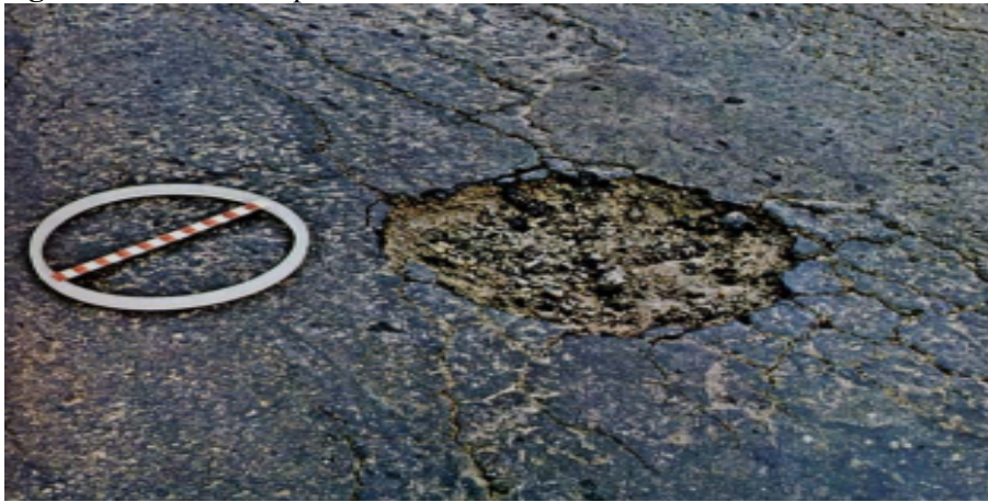
Figura 10: Buraco ou panela
