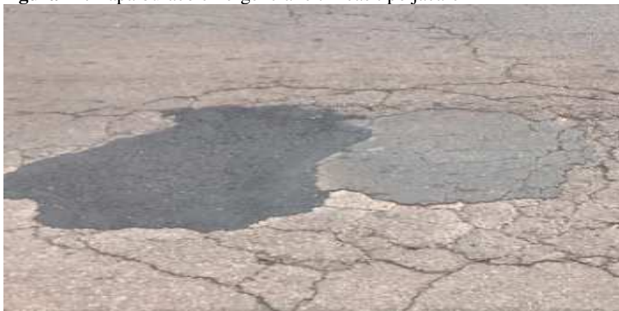
Figura 14: Tapa buraco emergencial e trincas tipo jacaré
