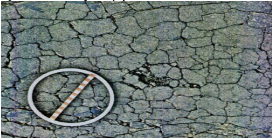
Figura 8: Trinca interligada - tipo jacaré
