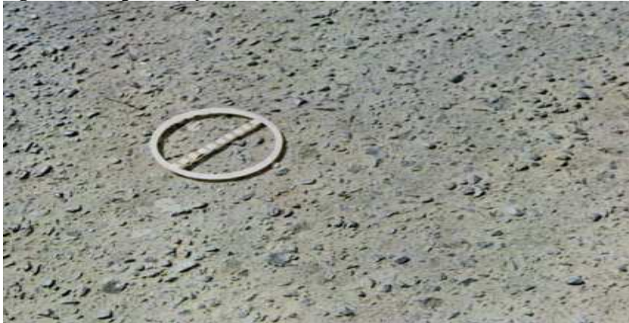
Figura 4: Desgaste do pavimento
