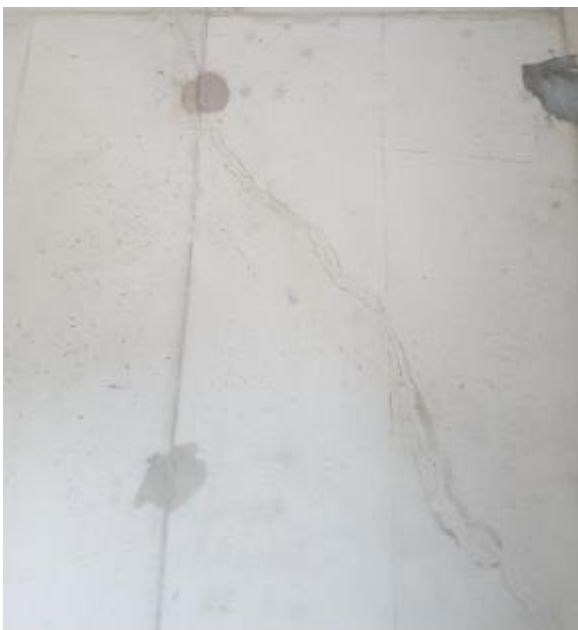
Figura 05: Fissuras da parede 1 do bloco 09
