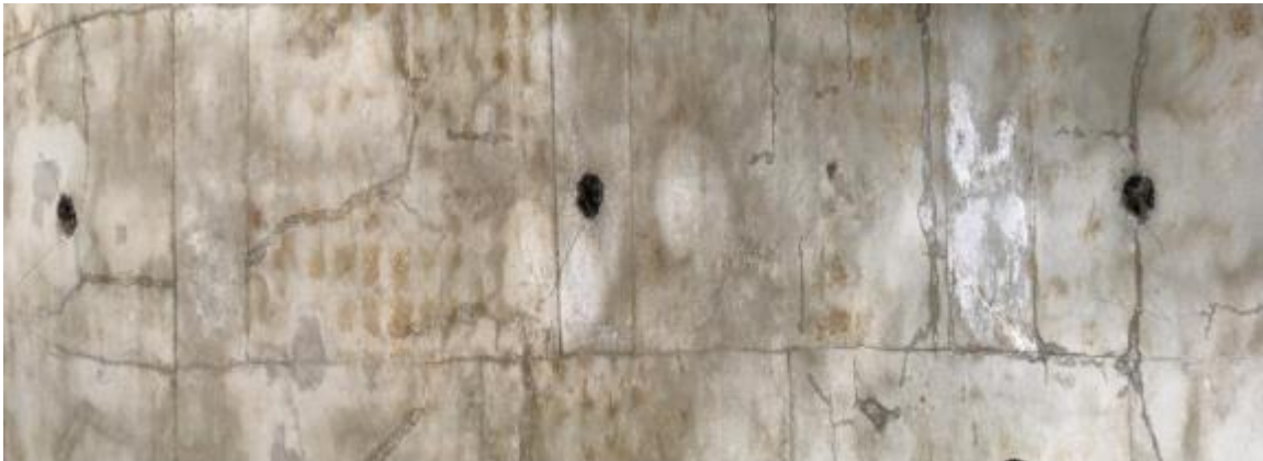
Figura 4: Fissuras parede 1 do bloco 01
