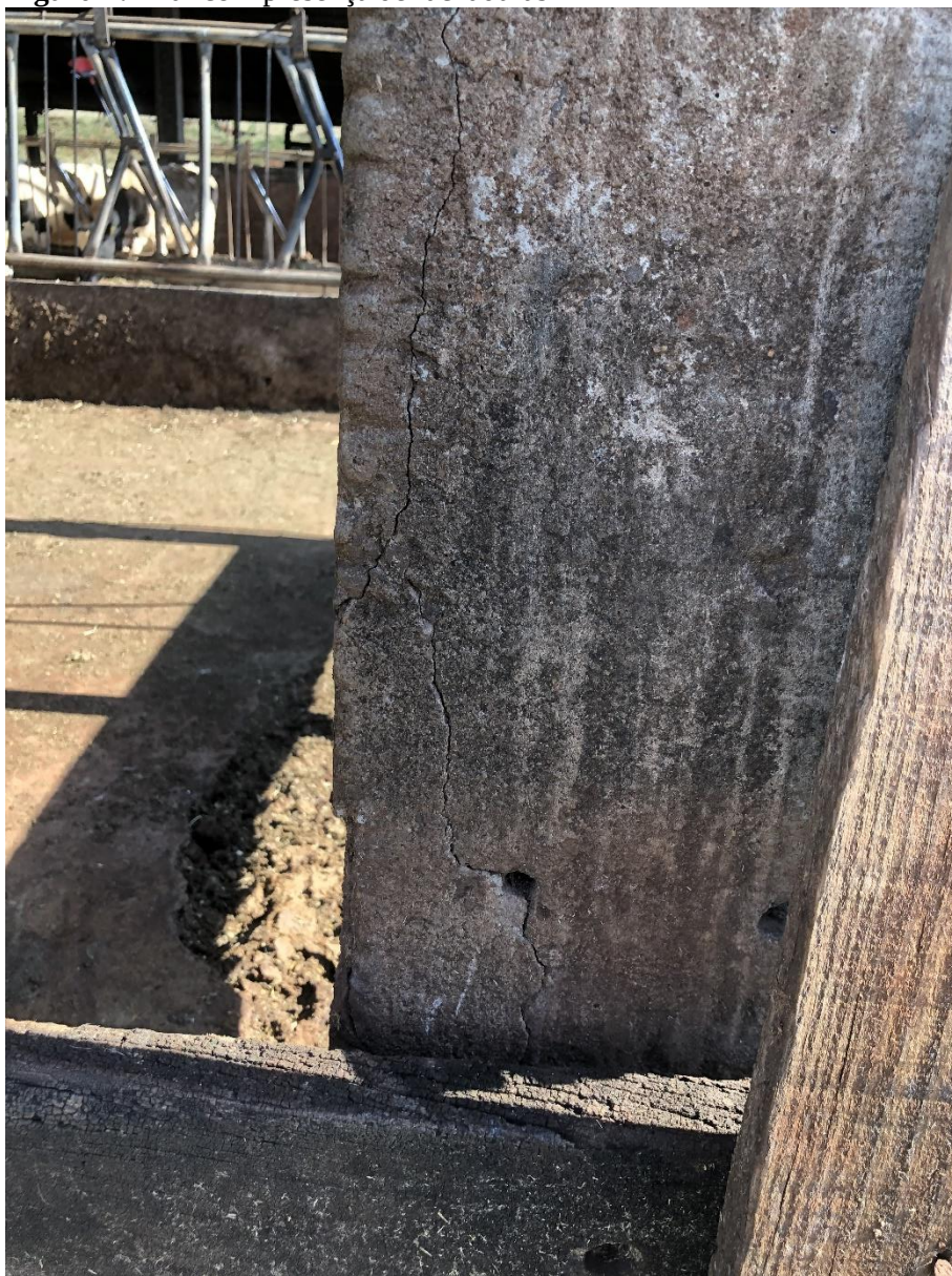
Figura 2: Pilar com presença de rachaduras
