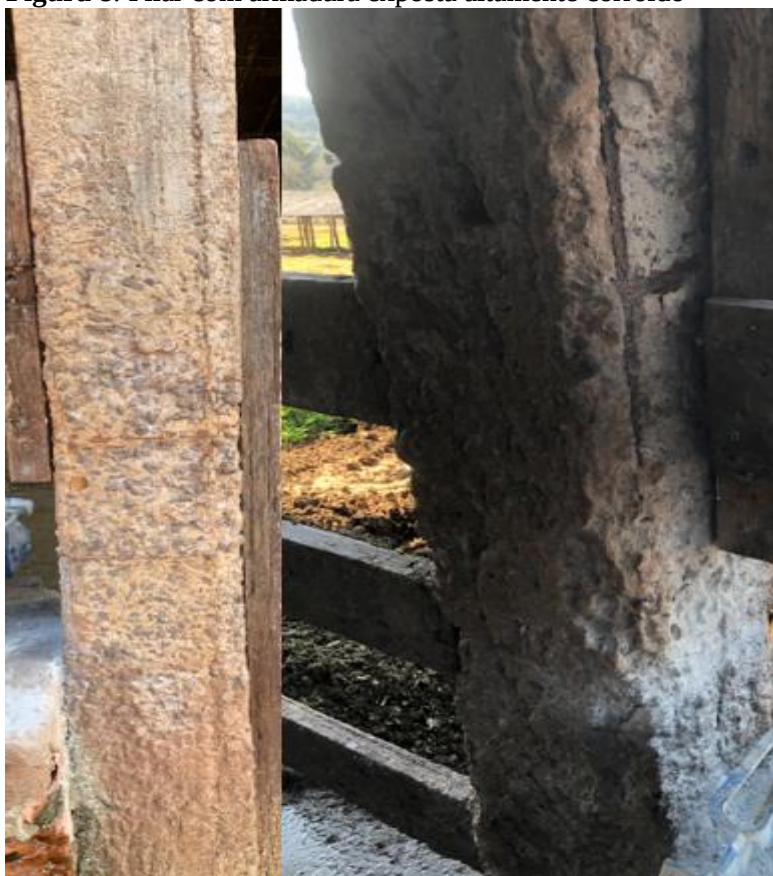
Figura 8: Pilar com armadura exposta altamente corroído
