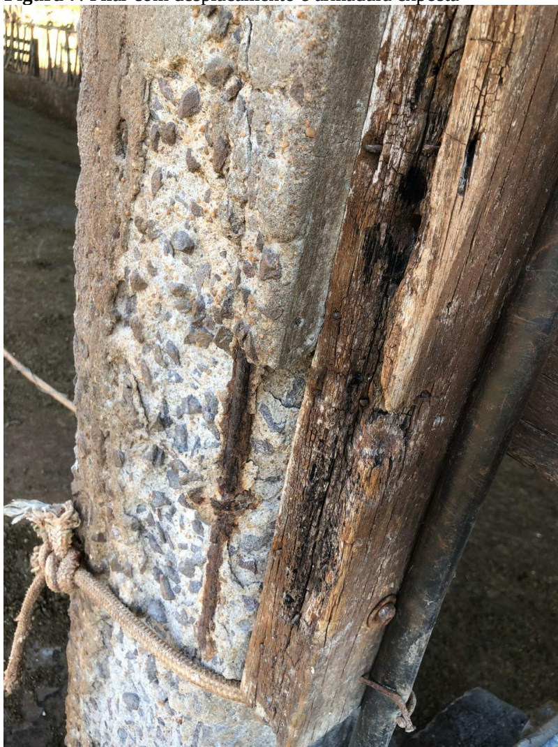
Figura 7: Pilar com deslocamento e armadura exposta
