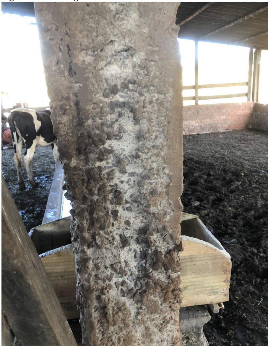
Figura 1: Pilar com grave corrosão.
