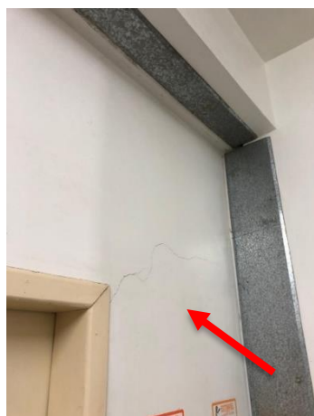
Fissura na parede
