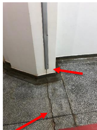
Rachadura no piso e pilar
