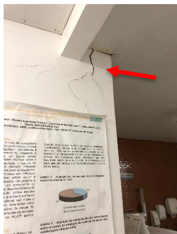
Rachadura na parede
