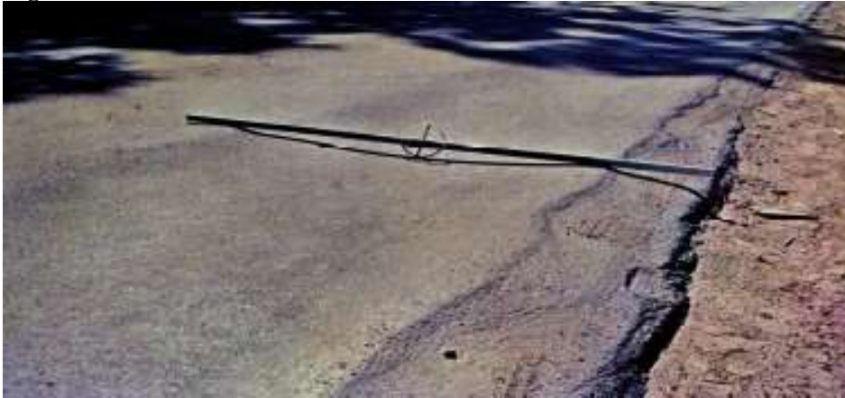
Figura 05: Afundamento de trilha de roda
