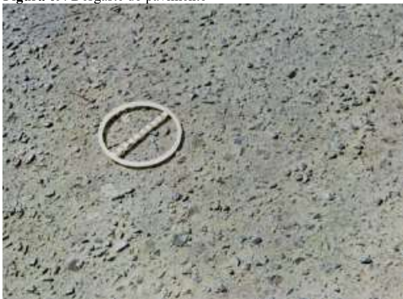
Figura 09: Desgaste do pavimento
