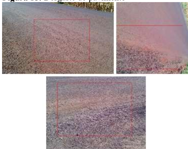
Figura 18: Desgaste do pavimento
