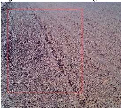
Figura 17: Trinca isolada longitudinal longa
