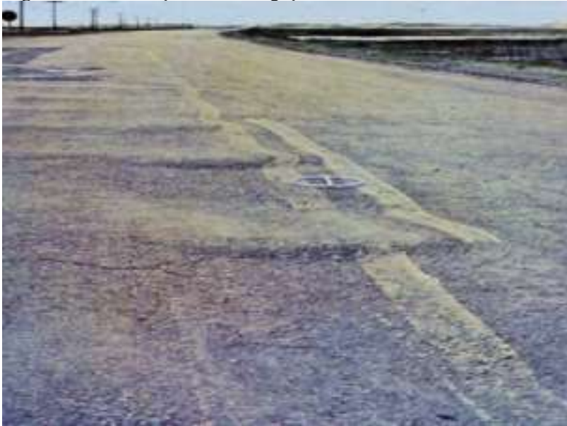
Figura 06: Ondulação ou Corrugação
