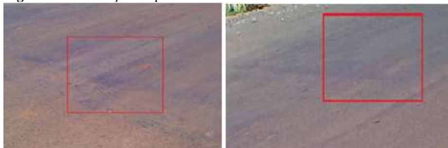
Figura 19: Exsudação do pavimento
