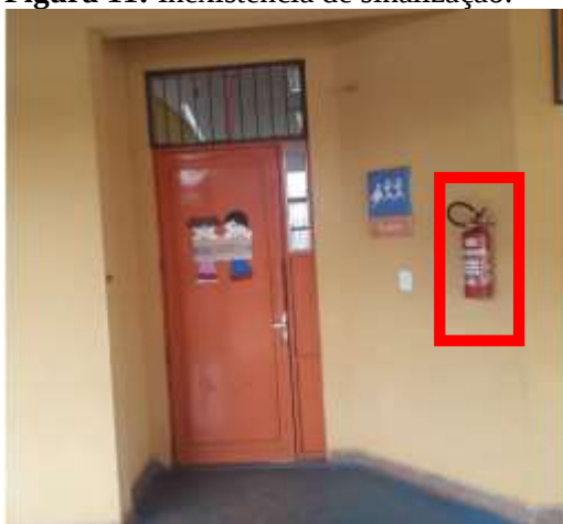
Figura 11: Inexistência de sinalização.
