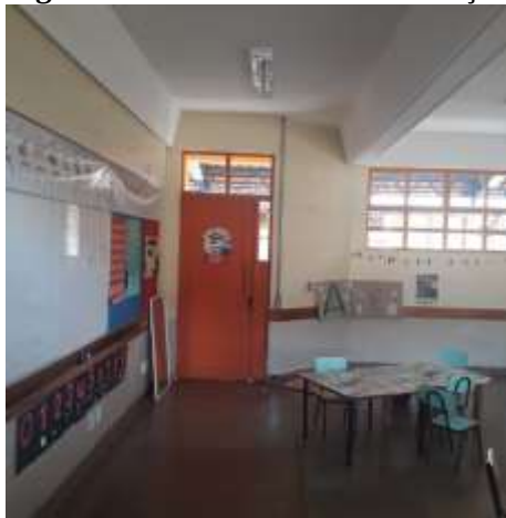
Figura 12: Inexistência de sinalização.
