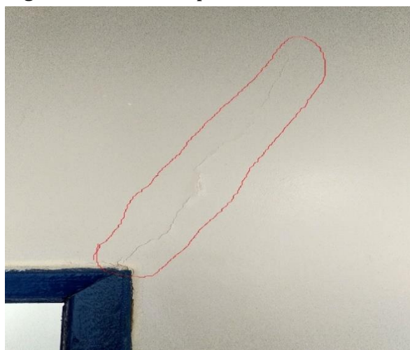
Figura 14: Fissura em parede.
