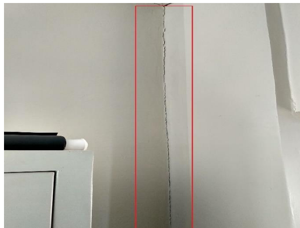
Figura 10: Fissura vertical por falta de amarração
