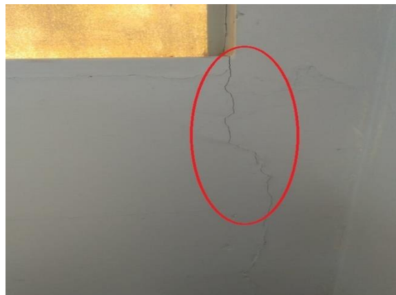
Figura 8: Fissura diagonal no vértice inferior
