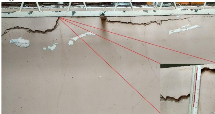
Figura 11: Rachadura horizontal em parede
