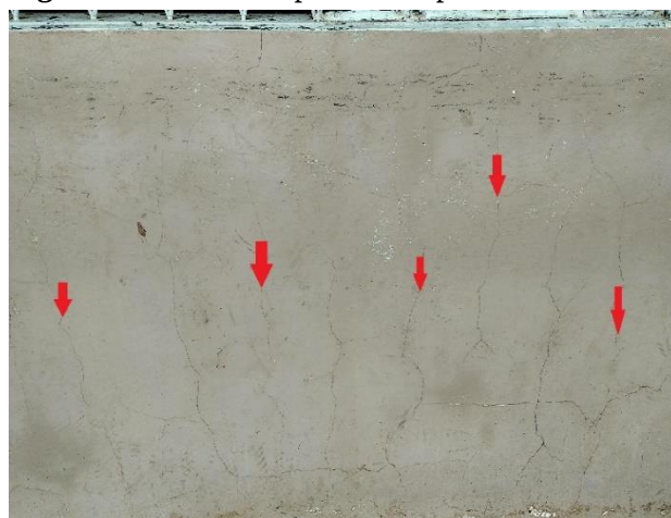
Figura 6: Fissuras mapeadas em parede externa
