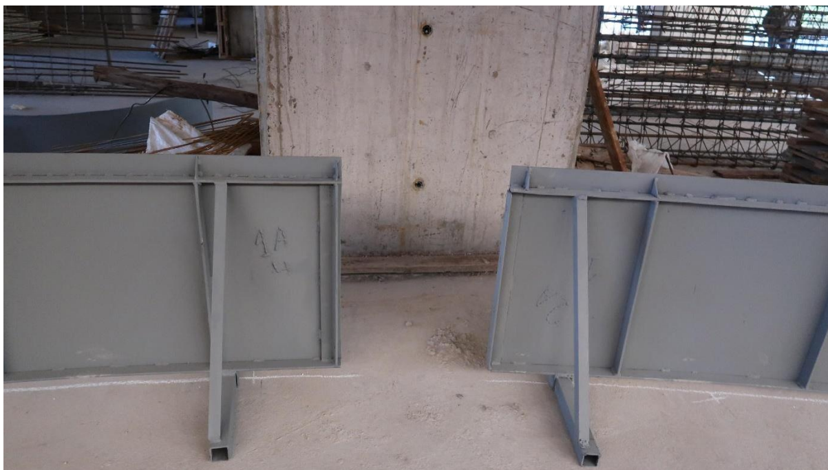
FIGURA 22: Peça de chapa que faltou.
