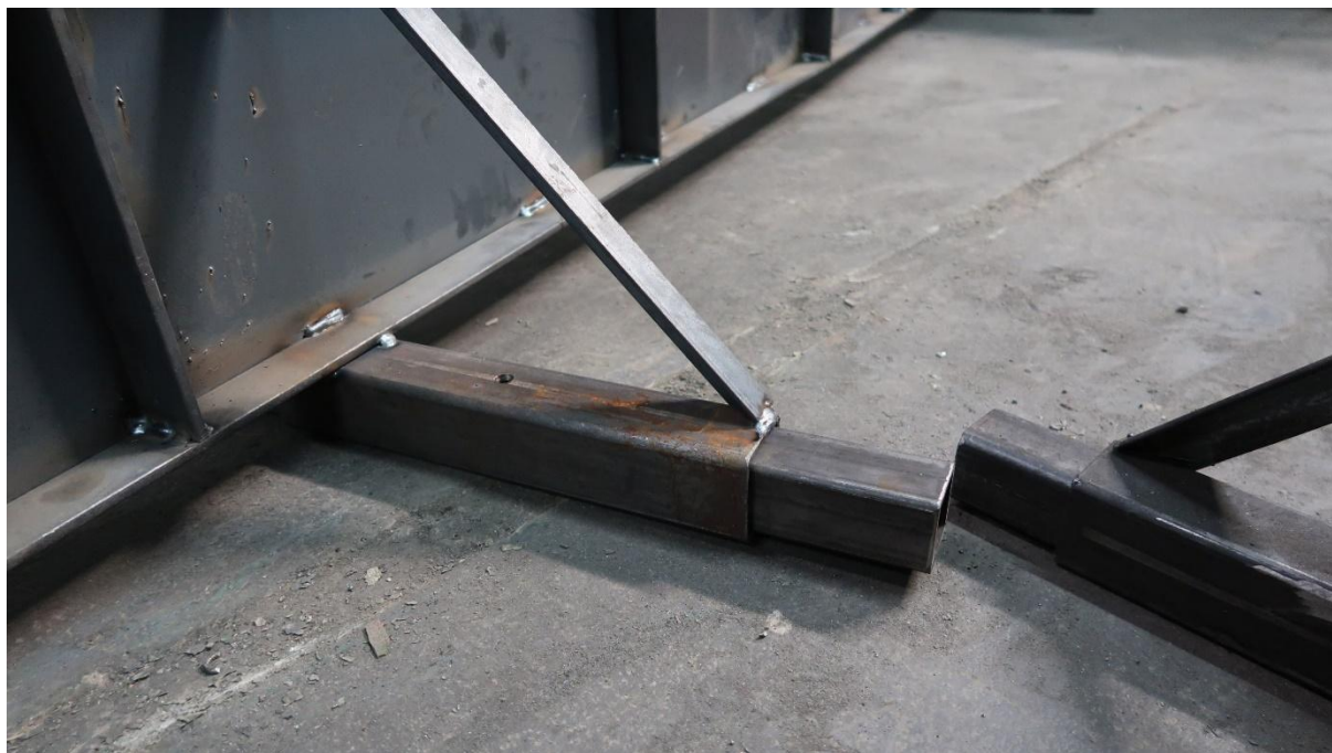
FIGURA 30: Sistema antigo de fixação por tubos.
