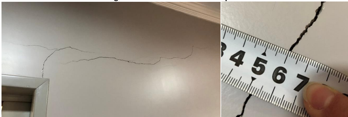
Figura B – Trinca a 45° acima da porta
